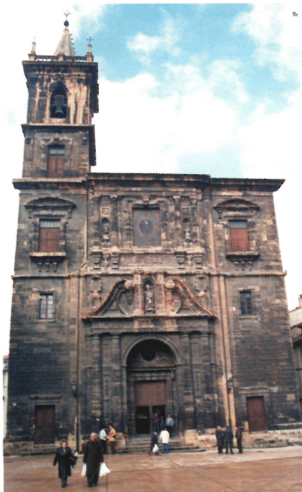
Vista general de la fachada de la iglesia de San Isidoro, de Oviedo. Se observa el ennegrecimiento de la piedra en casi toda la fachada a causa de la pátina de suciedad
