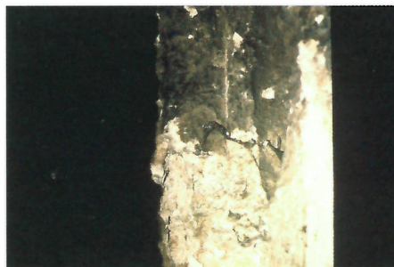
19. Desmoronamiento. Claustro de la catedral de Burgos
