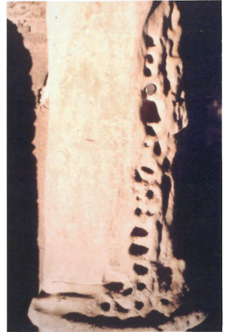
21. Alveolización. Palacio de Revillagigedo (Gijón)
