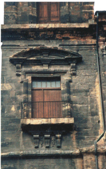
1. Aspecto del balcón izquierdo de la fachada, con abundantes pátinas y costras negras.
