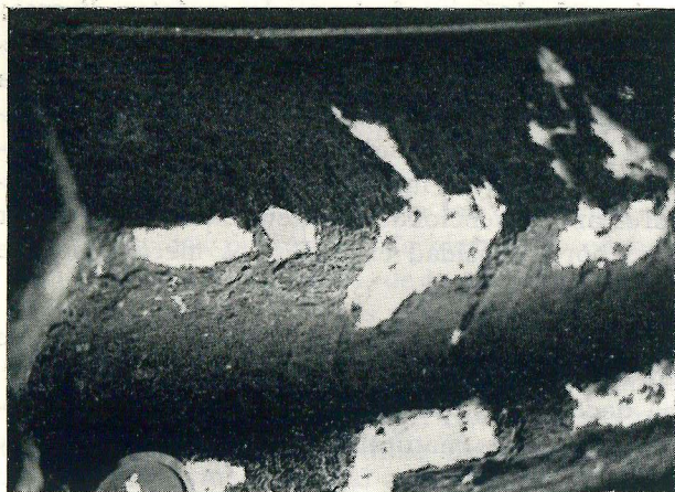
Figura 11.—Aspecto de la pátina de ennegrecimiento que presenta la dolomía de la Iglesia de los Franciscanos. La fotografía recoge una zona en la que el material, debajo de la pátina, está seriamente alterado, habiéndose generado desplazaciones importantes.
