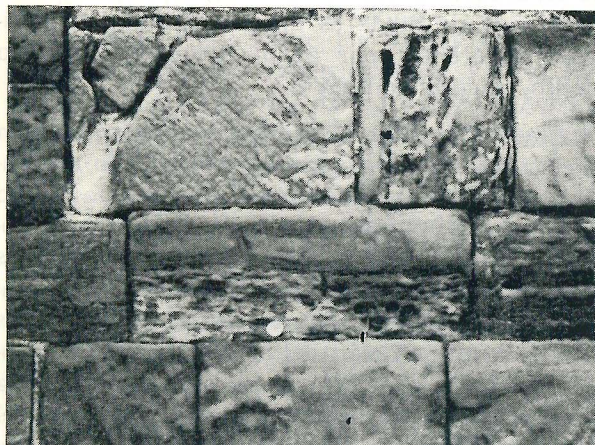
Figura 12.—Acanaladuras, fenómenos de abrasión y alveolos implantados en algunos de los sillares de la arenisca de la Iglesia de los Franciscanos. Obsérvese que la implantación de los alveolos está relacionada con la posición de los bloques y de sus planos de estratificación.
