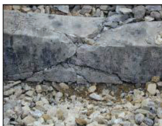
Figura 1a. Daño en una traviesa de hormigón
