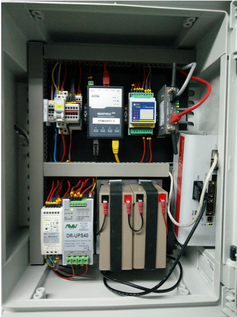
Figura 5.40. Armario de monitorización para las plantas fotovoltaicas. Además del gateway IIoT, dispone de alimentación, batería de refuerzo, módem y un módulo de entradas y salidas auxiliar para usos varios.
