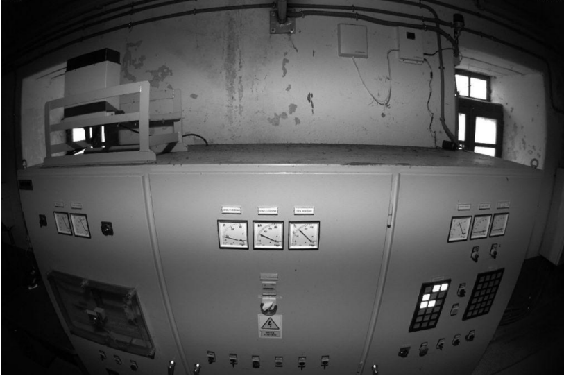
Figura 5.20. Panel de monitorización analógica de Cerroalto visto desde la cámara de inspección instalada. Se pueden apreciar medidores de aguja y paneles luminosos para mostrar alarmas y otras señales digitales.
