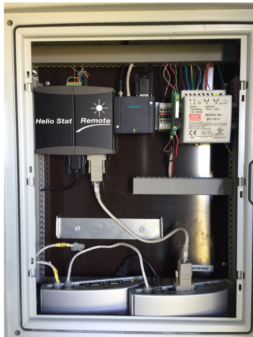
Figura 5.33. Armario de monitorización de SolarWatch. Esta solución fue contratada inicialmente por TSK para la supervisión de las plantas fotovoltaicas desde el centro de control.
