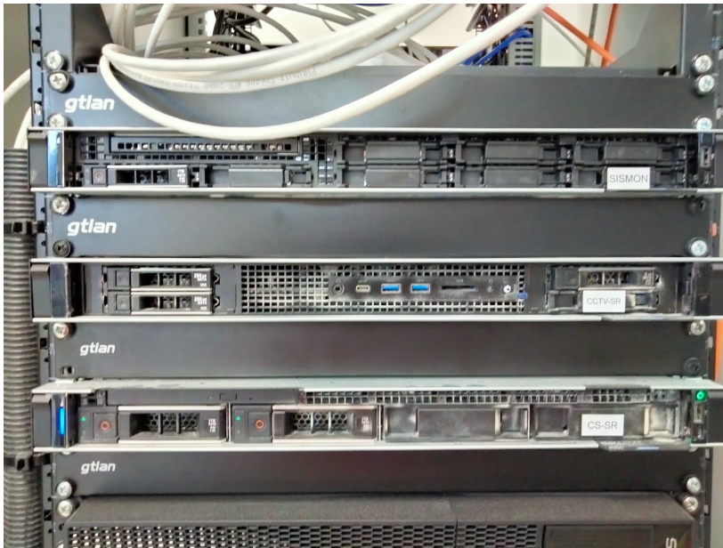
Figura 5.17. Equipo empleado como Gateway IIoT en Baní. Se instaló en el interior de un armario de servidores o rack y debía respetar el factor de forma propio de estos equipos.
