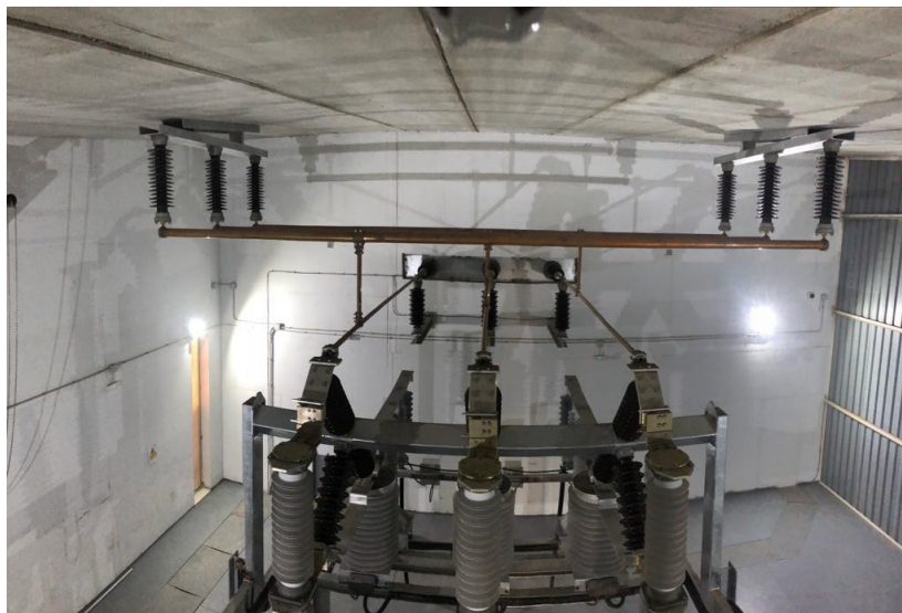
Figura 5.28. Vista de la cámara instalada en Granadilla. En una sola imagen es posible monitorizar todos los embarrados de la subestación.
