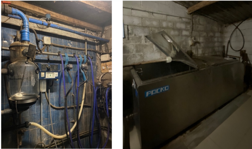
Ilustración 6. A la izquierda se ve la instalación del ordeño directo durante el proceso de lavado automático y a la derecha el tanque al que llega la leche durante el ordeño.
