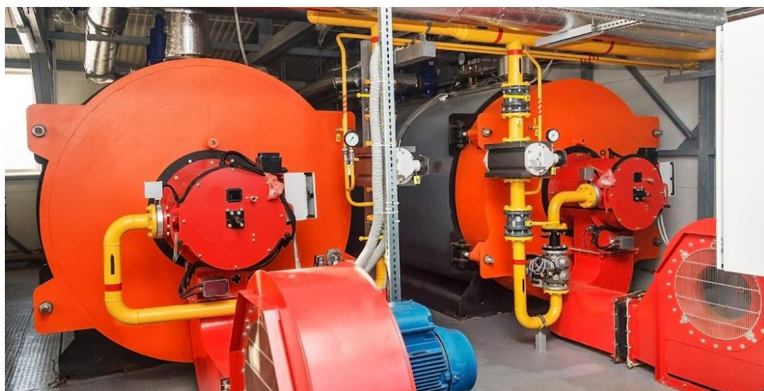
Figura 25. Configuración en módulos de producción de energía térmica.
