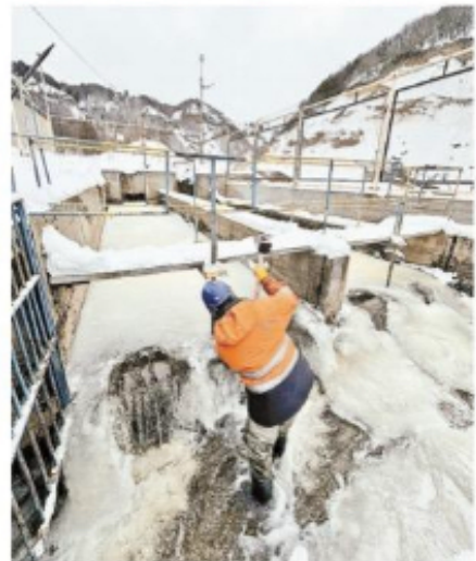
Cada invierno trabajadores y contratistas de Aguas Magallanes realizan arduas tareas para mantener el flujo constante de las fuentes de agua cruda. En la foto, un operario rompe el hielo profundizado con un combi.
