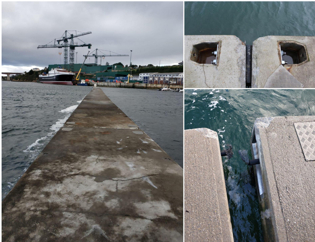
Figura 11. Dique flotante de Figueras (panel izquierdo), detalle de conexión funcionando correctamente (panel superior derecho) y detalle de rotura tras temporal (panel inferior derecho).
