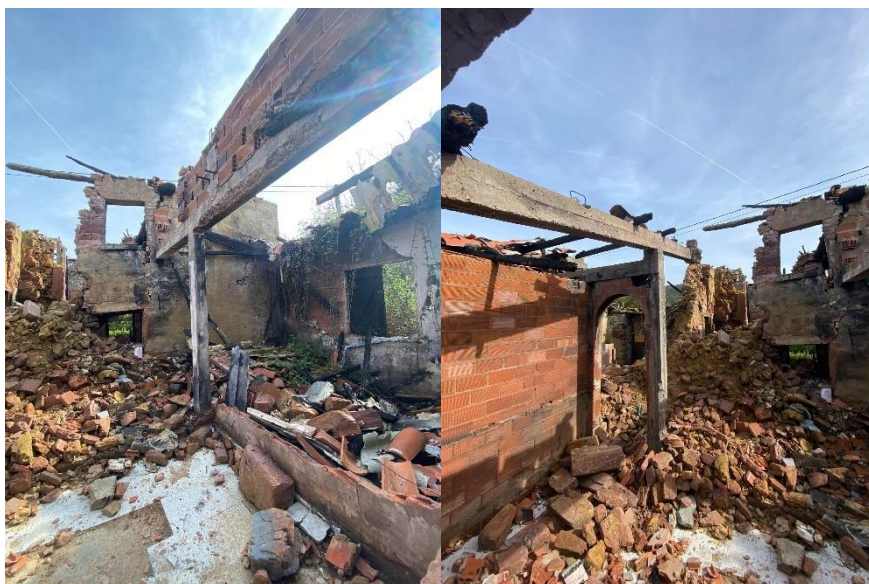
Figura 22: Vivienda destruida en Cortina, Trevías, mediante paveseo
