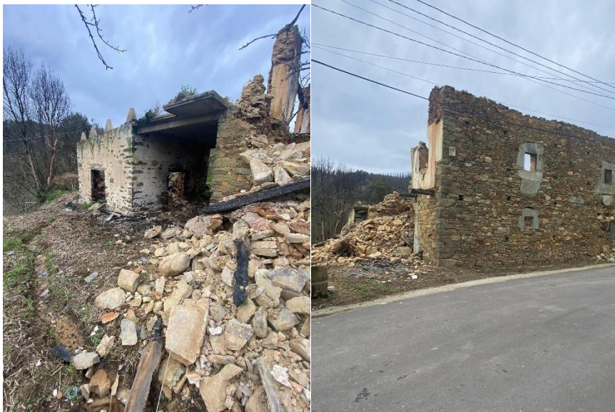
Figura 21: Vivienda destruida en Bahinas, Trevías, por exposición directa del fuego
