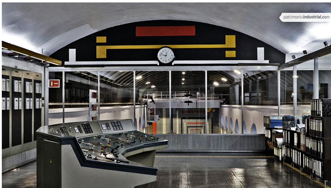
Fig. 4b. Centro de control de la central de Miranda. Al fondo puede observarse la intervención desarrollada en la sala de máquinas basada en el sabio manejo de la luz y del color. Fotografía: patrimoniuiindustrial.com
