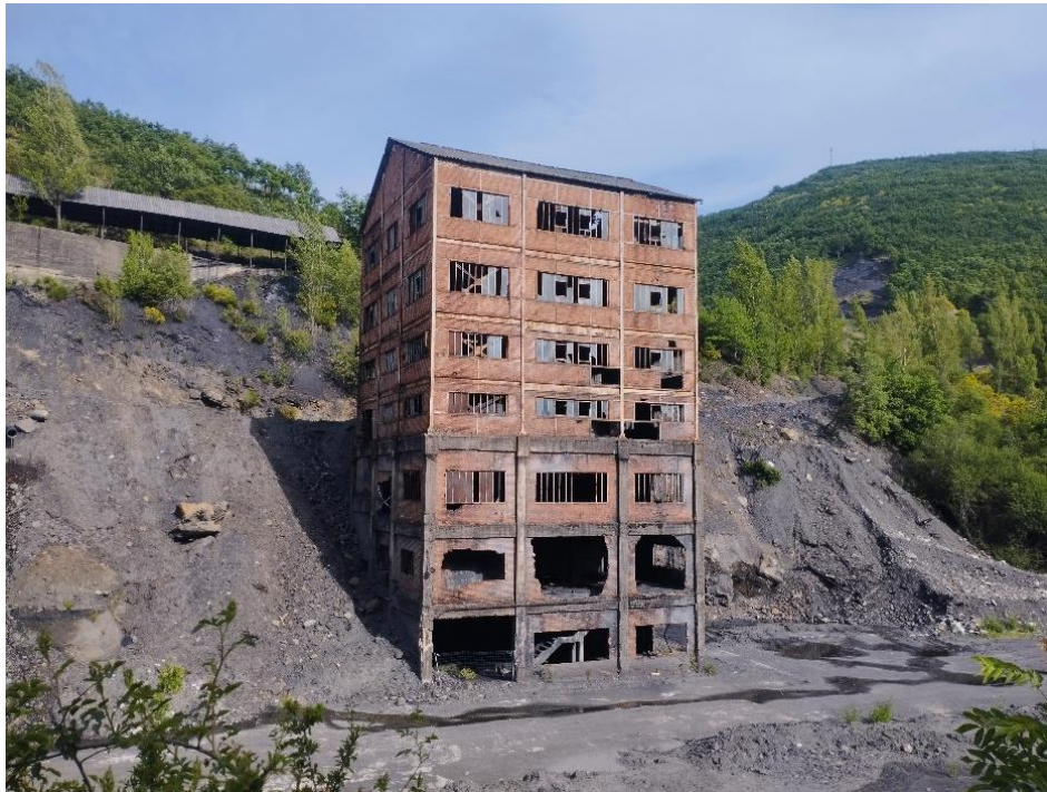
Figura 49. Lavadero de carbón del Pozo Casares en Tremor de Arriba actualmente, 2024. Fuente: fotografía del archivo personal de la autora.
