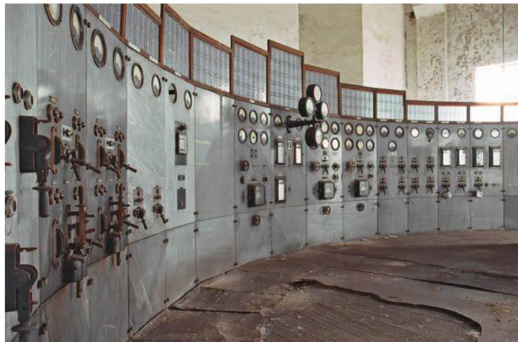
Figura 28. Sincroscopio en el momento de su reinstalación en la Fábrica de Luz. Fuente: Centro de Documentación de La Térmica Cultural.
