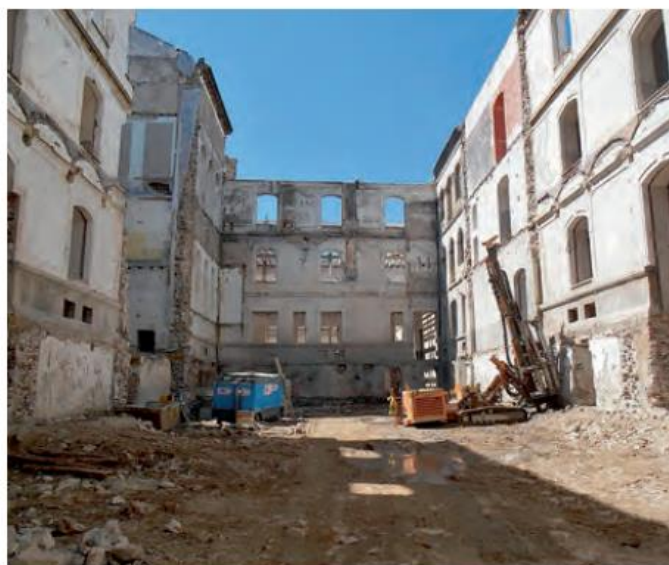
Figura 17. Proceso de demolición de las estructuras interiores del edificio. Fuente: Jon Esnaola Egaña, «Rehabilitación de la antigua Fábrica de Tabacos, San Sebastián. Una reflexión en tres direcciones», CERCHA , n.º 131 (2017). 19-21.
