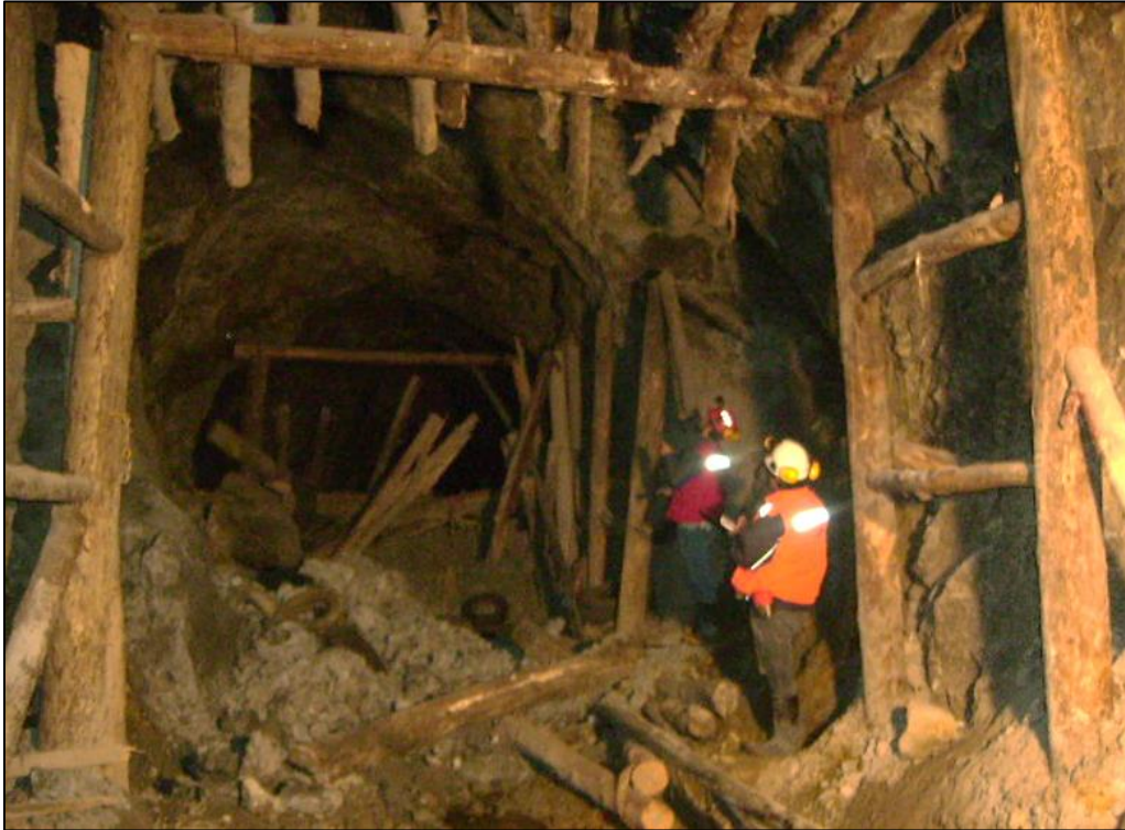
Figura 5.7. Derrumbe de material en sector de mala calidad geotécnica, el cual afecta la integridad del sistema de soporte constituido por enmaderado, y genera el colapso en el túnel de acceso de una mina subterránea de “pequeña minería” (fotografía tomada por Fernández, 2018).
