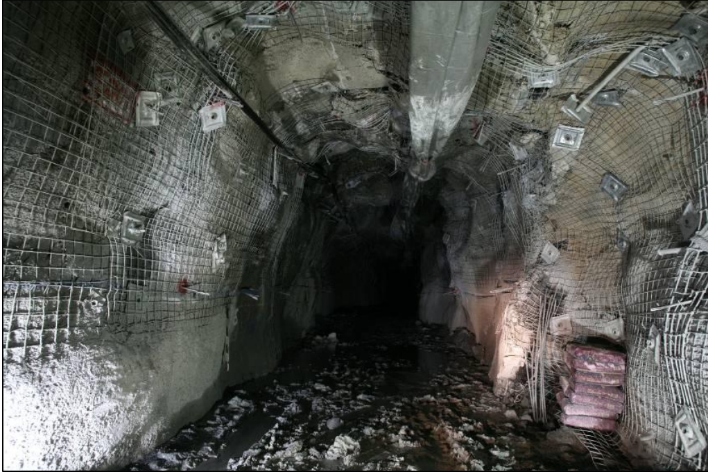
Figura 5.16. Ejemplo de una severa convergencia (“Squeezing”) en una galería del nivel de hundimiento de una mina de block caving (Fernández, 2011).
