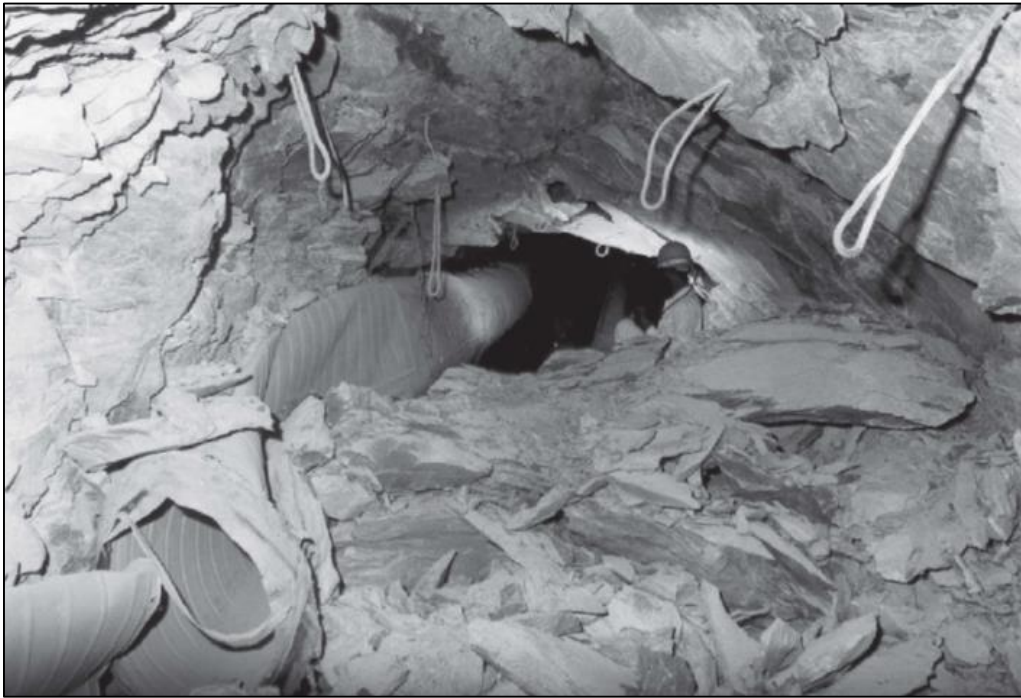
Figura 5.13. Estallido de rocas (“rockburst”) severo, con colapso de una galería en una mina de hundimiento de bloques (Stacey & Rojas 2013).
