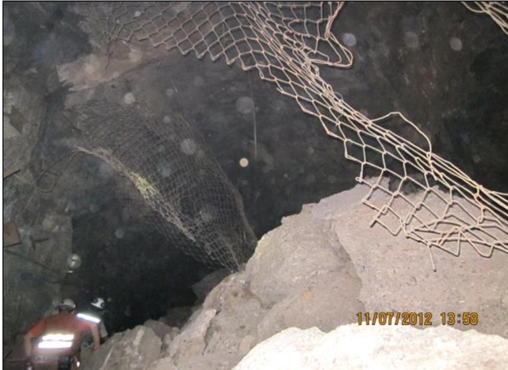
Figura 5.8. Desprendimiento severo de bloques que genera el colapso del sistema de soporte y pérdida de la funcionalidad y operatividad de una excavación, en una mina subterránea (Fotografía tomada por Fernández, 2012).
