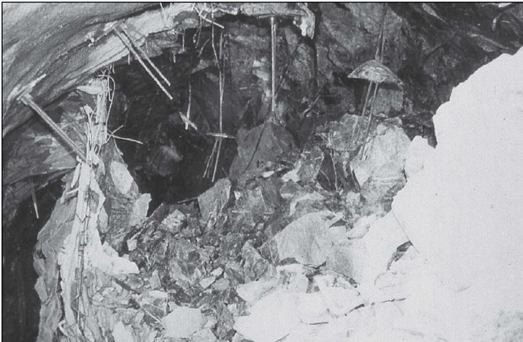
Figura 5.14. Estallido de rocas (“rockburst”) severo, con colapso de una galería y presencia de cables colgando, en una mina de hundimiento de bloques (Stacey & Rojas 2013).
