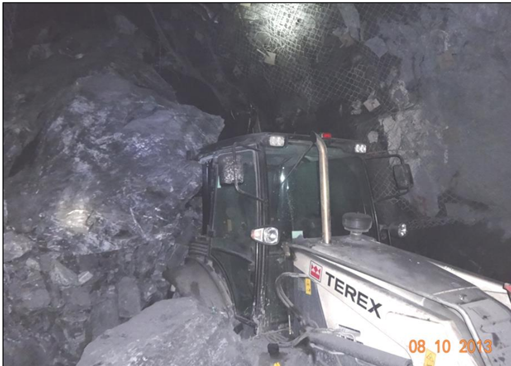
Figura 5.9. Desprendimiento severo de bloques que genera el colapso de una galería, afectando un equipo de "scaling" (Fotografía tomada por Fernández, 2013).
