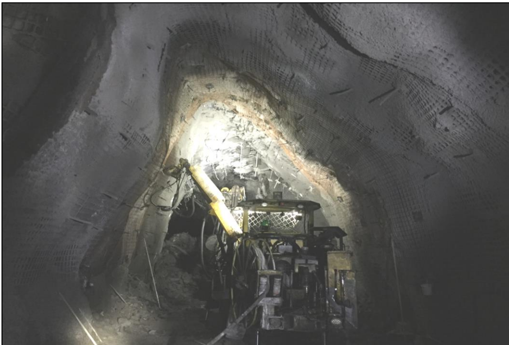
Figura 5.6. Sobre-excavación generada en el techo de una galería, asociada al desprendimiento de una cuña formada por planos de falla. Se observa el proceso de reparación de daños a través de la instalación de un sistema de soporte (Fotografía tomada por Fernández, 2018).
