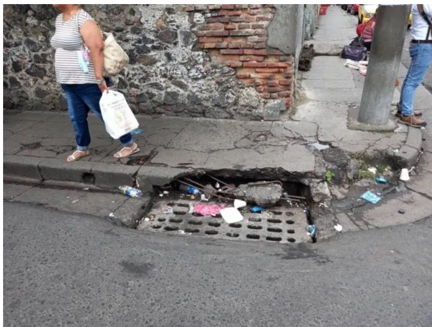
Ilustración 12: Acumulación de basura en los desagües de San Salvador
