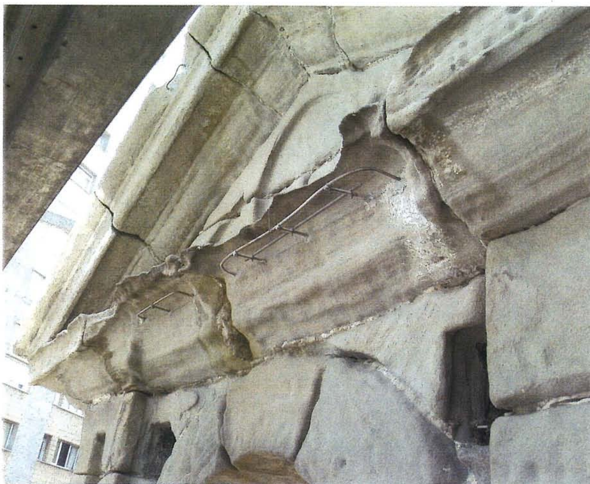
Figura 10: Armado de la cornisa de la espadaña. Figure 10. Framework of the belfry cornice.
