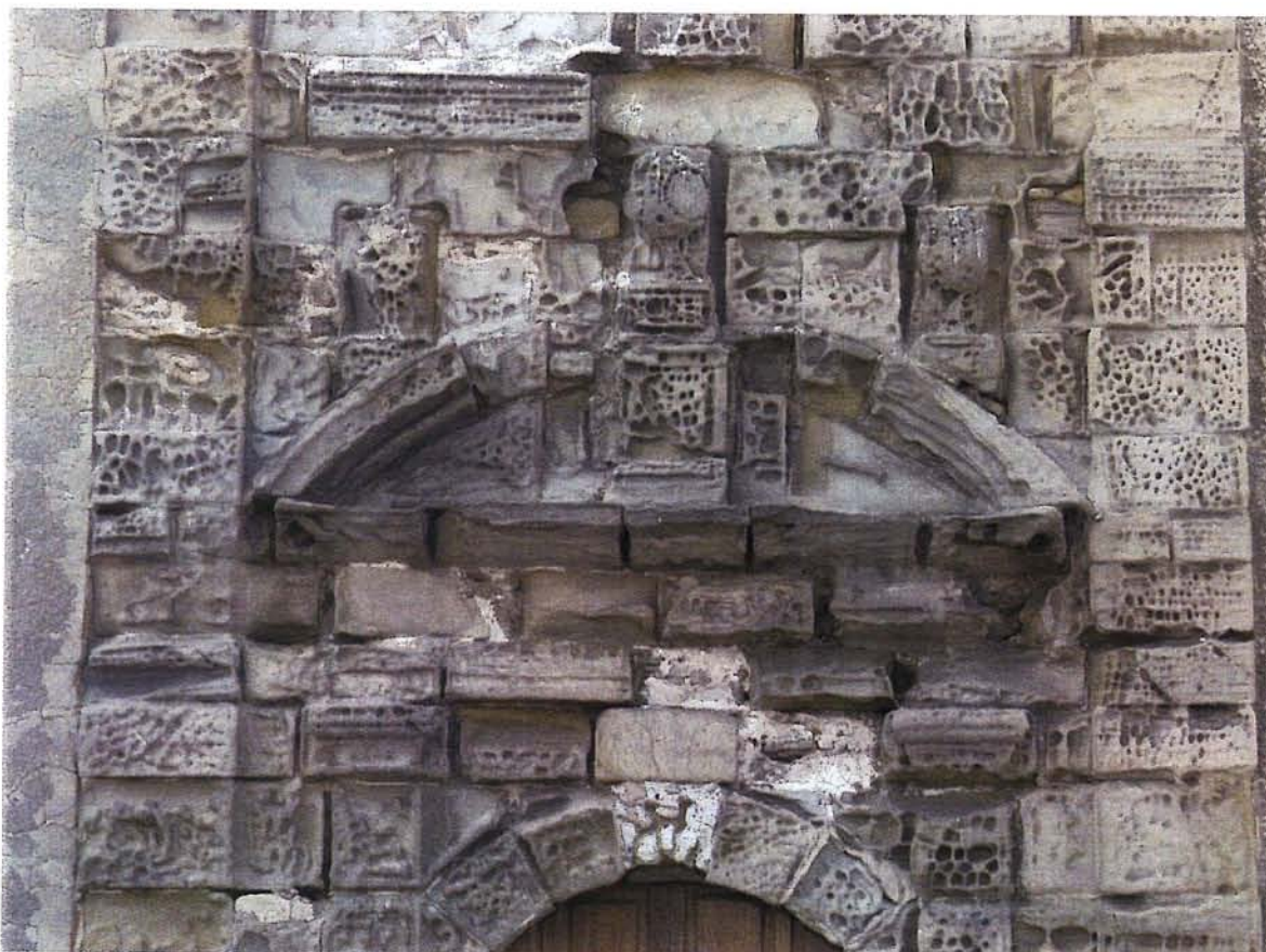
Figura 4: Detalle de la parte central de la capilla donde se observan distintas formas de alteración: alveolos, acanaladuras, descamaciones, etc. Todas estas patologías conllevan importantes pérdidas de material Figure 4. Close up of the central part of the chapel where different types of deterioration are in evidence: alveolation, grooves, scales, etc. All of these alterations cause stone loss.
