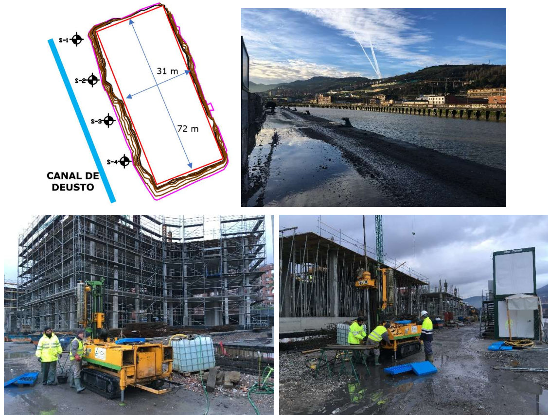
Figura 82. Vista en planta de los nuevos sondeos con relación a la parcela y al canal y fotografías durante la ejecución
