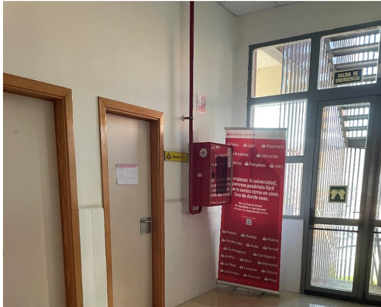
Figura 3.59 Fotografía de una manguera de incendios de la segunda planta
