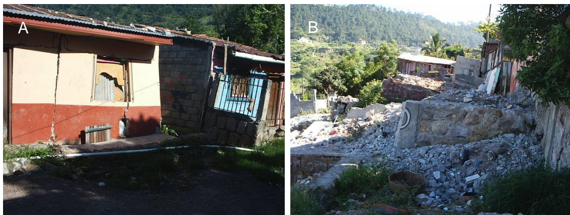
Figura 45. Ejemplos de daños sobre la colonia Nueva Santa Rosa. A. Viviendas agrietadas. B. Viviendas totalmente destruidas. Ambas fotos se sitúan sobre el deslizamiento A de la colonia Nueva Santa Rosa. Fuente: fotos propias, mayo 2009.
