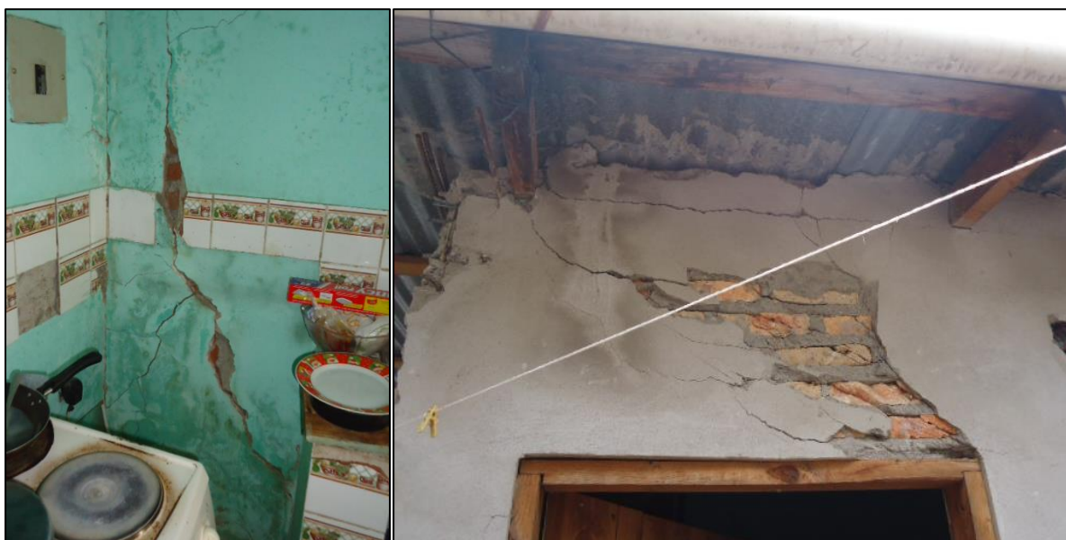
Figura 81. Ejemplos de viviendas de ladrillo con grietas originadas por movimientos de ladera en las paredes. Se aprecia que las viviendas no cuentan con columnas o vigas. Fotos cortesía de la ONG GOAL, encuesta del año 2010.
