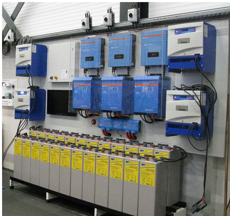
Figura 2.20.- Banco de baterías de una instalación solar [24].
