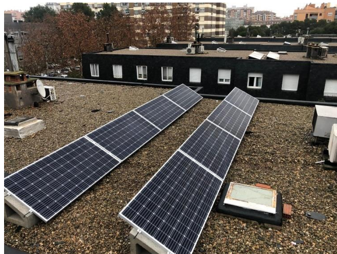
Figura 2.16.- Paneles solares en dispuestos de forma general [19].
