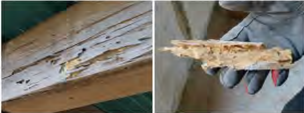
Figuras 1 y 2. Ataques de Hylotrupes bajulus en vigas de madera laminada.
