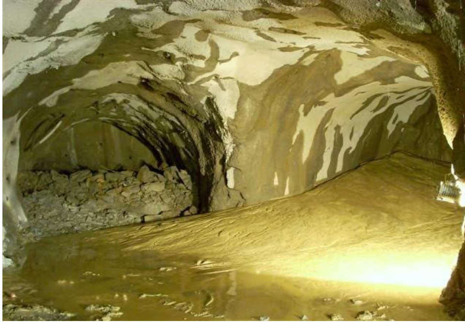
Fig. 18 Lodos ocasionados por la entrada de agua
