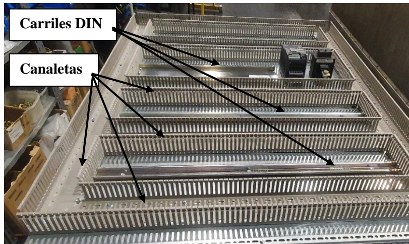
Figura 47. Cuadro eléctrico con carriles y canaletas, preparado para montaje de componentes. Fuente: fotografía propia.
