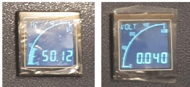
Figura 57. Frecuencímetro de red (izqda.) y de grupo (dcha.) sin configurar. Fuente: fotografías propias.
