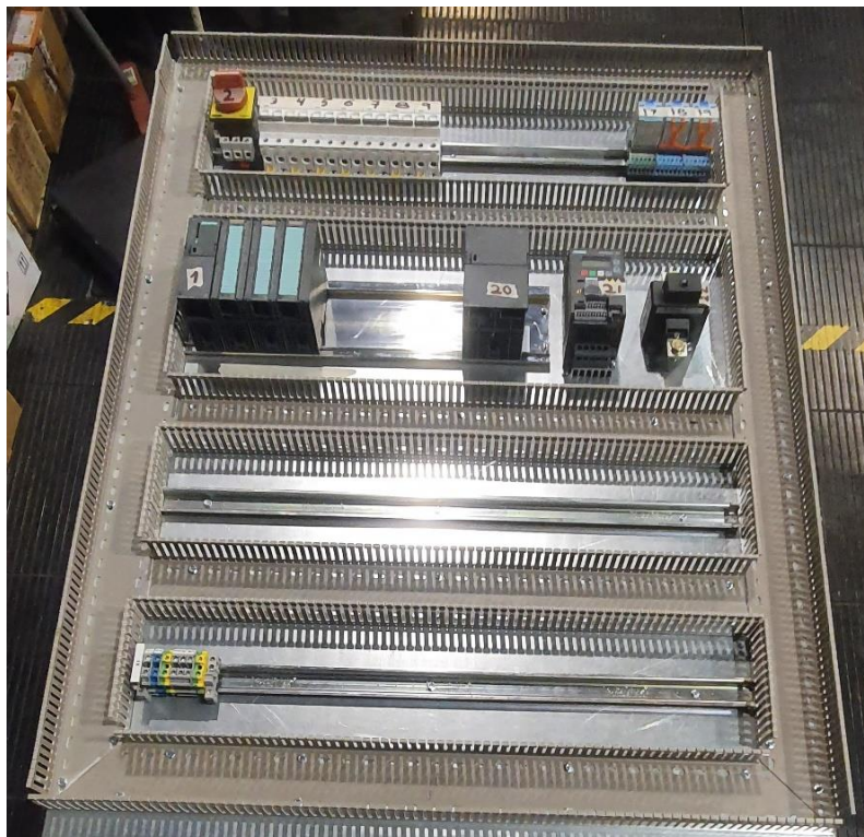
Figura 48. Cuadro eléctrico con algunos dispositivos montados, sin cablear. Fuente: fotografía propia.
