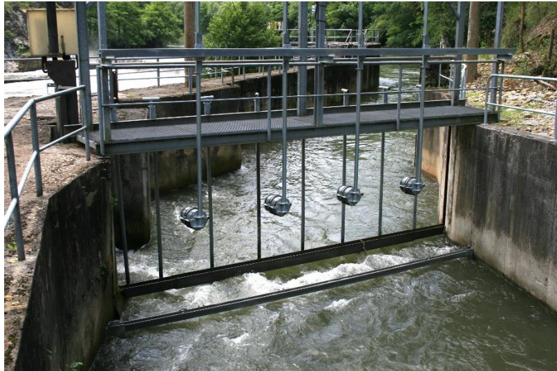
Figura 9. Obra de toma con barrera sónica de peces en la central hidroeléctrica de Nalón (Asturias). Fuente: Alnus (2005).
