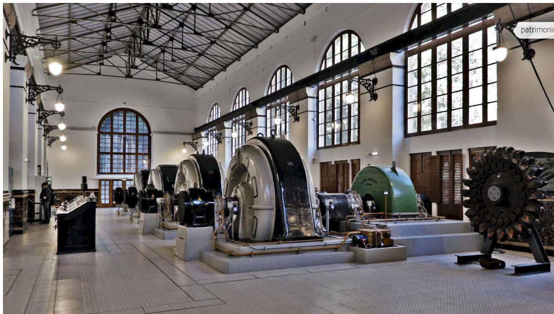
Figura 21. Interior de la central hidroeléctrica de la Malva. Fuente: Patrimonio Industrial de Asturias.
