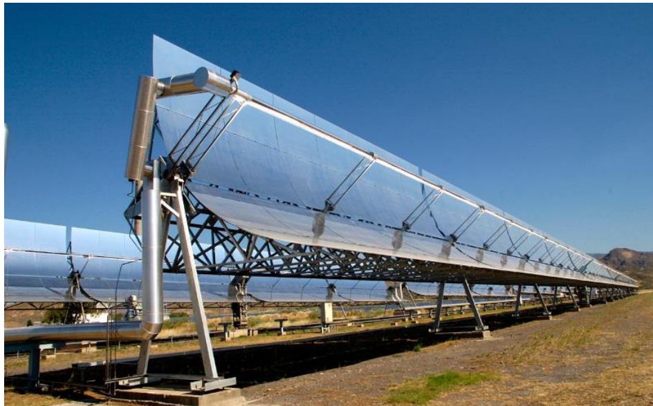
Figura 17: Colectores de cilindro parabólico [42]
