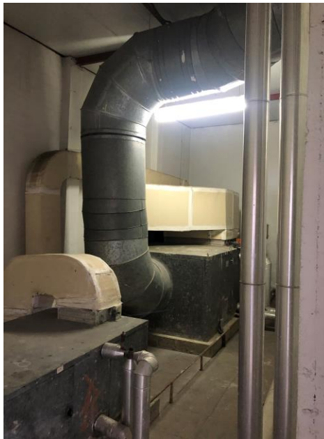
Ilustración 7.69. Sala de Climatizadores Edificio.
