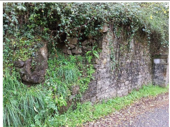
Detalle lateral del muro donde se observa la estructura interna en mampostería. Se aprecia la deformación y volcado del muro.
