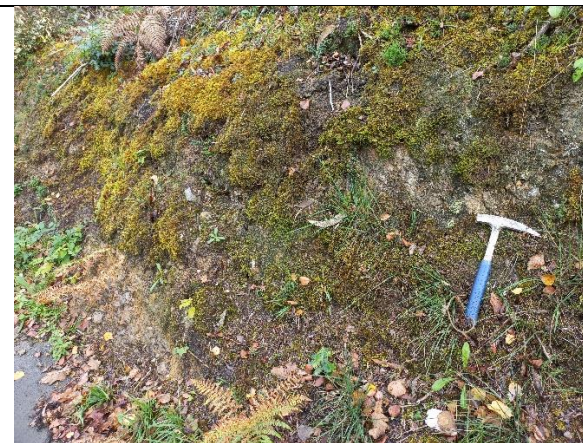
Afloramiento con PL 7, en PK 0+330. Disgregación del talud en chinos acumulados obstruyendo la cuneta de pie.
