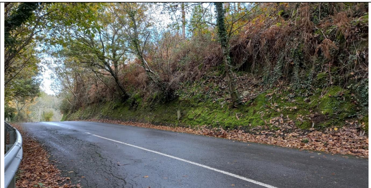
Vista del talud I desde su inicio en el PK 0+950. Se observan los árboles de la cara del talud inclinados así como abombamientos y deformaciones en la cara del talud en torno al PK 0+980. Cuneta de pie obstruida por tierra y hojarasca.
