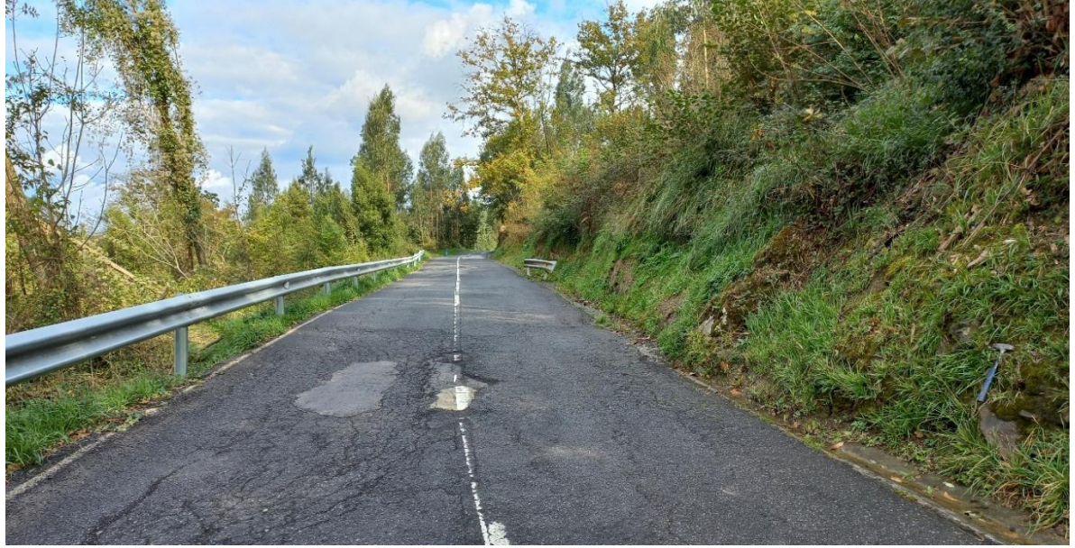
Vista general en el PK 0+210. Deterioro avanzado del asfalto con grietas, oquedades y parcheos. Talud derecho con PL 4 en coluviales, donde se observa un bloque de arenisca junto al martillo. Cuneta de pie deformada y abombamientos de la cara del talud.
