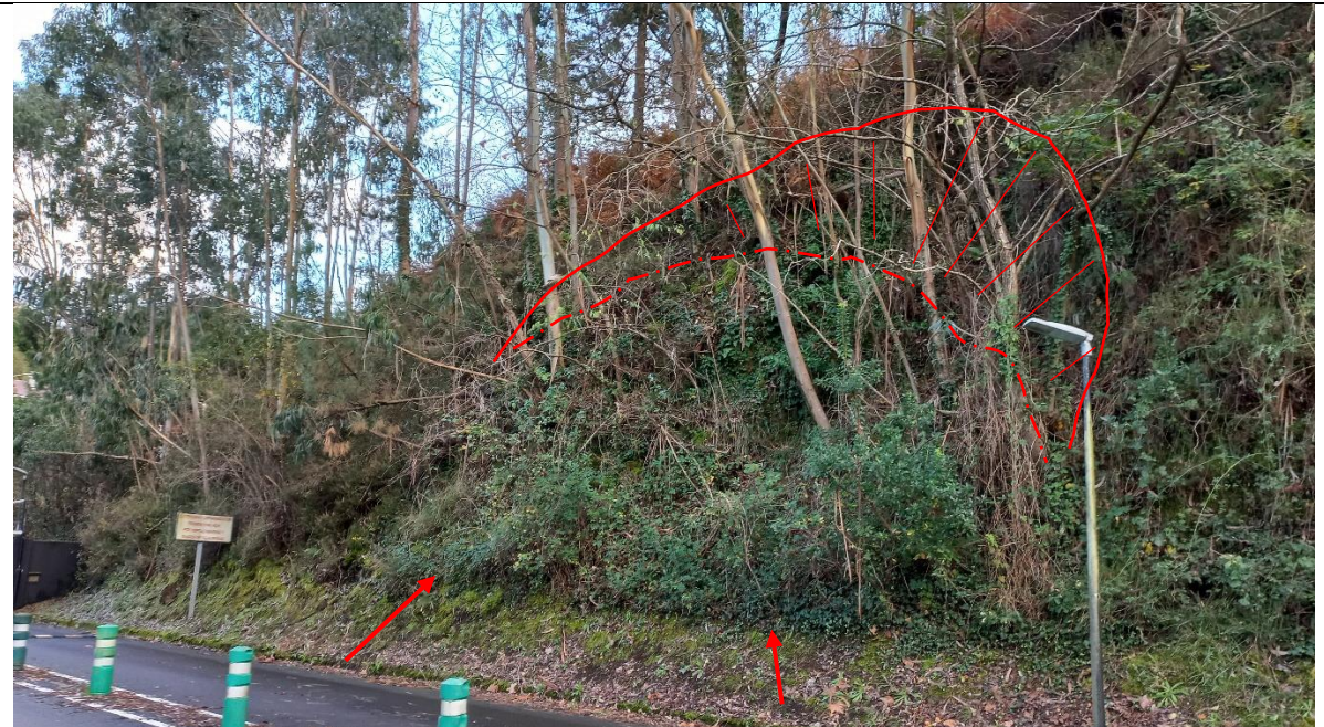
Final del talud y de la carretera de acceso a la urbanización. Se aprecia un abombamiento de la cara del talud indicando de una rotura a través del contacto entre eluvial y la masa de roca alterada, en el PK 1+590.
