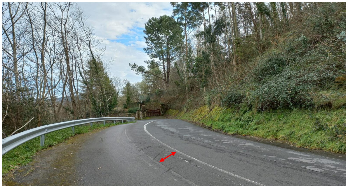
Vista general del talud H hacia el final, desde el PK 0+660 tras la curva. Se observa una modificación del eje central del vial (señalado con flechas rojas) y hundimientos en el margen exterior del carril derecho.
