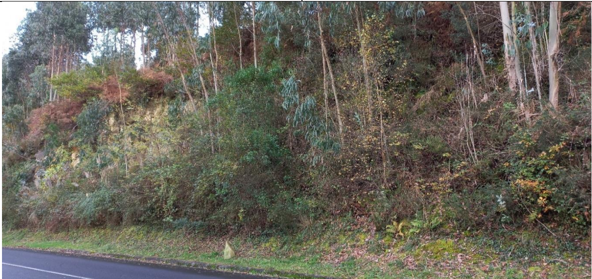
Vista del talud en el PK 1+330. Tramo de 15 m de altura donde se establece el PL 17 en la parte inferior. La abundante vegetación de la parte inferior del talud dificulta la toma de datos y observación de inestabilidades. Se encuentra un bloque de 40 cm de lado aproximado depositado a pie de talud.
