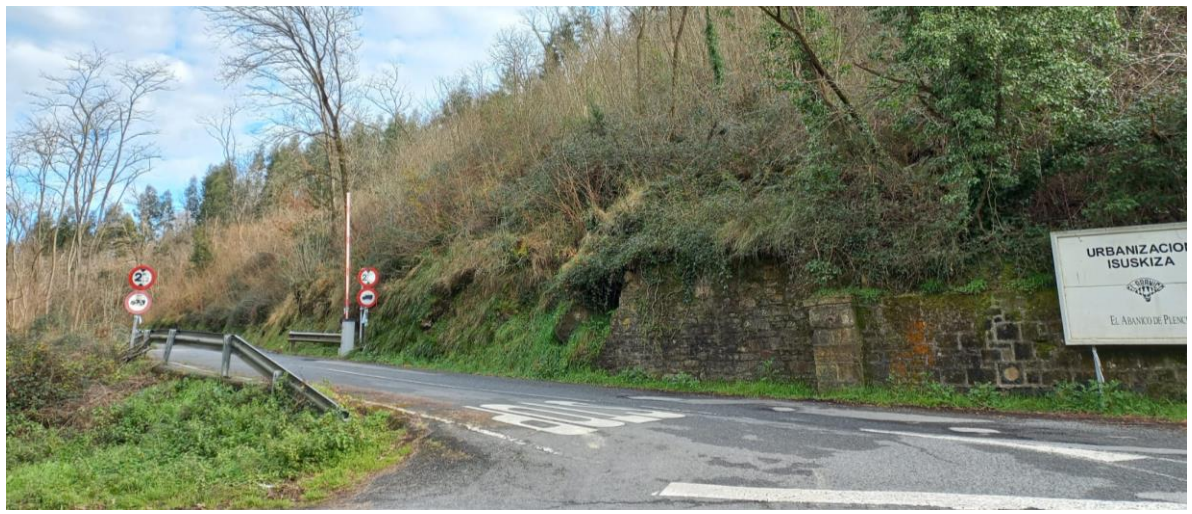
Vista general del inicio de la carretera de acceso a la urbanización en PK 0+000. Inicio del talud A con muro de mampostería con recubrimiento de sillería a comienzo del tramo.
