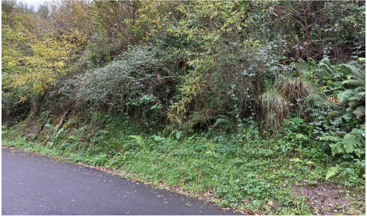
Vista general del PK 0+020 con talud excavado en coluviales. No se observan deformaciones ni inestabilidades relevantes. PL 1.
