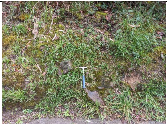
Tramo en coluvial en PK 0+230, con roturas en la cara del talud y caída de bloques cm-dm de arenisca
