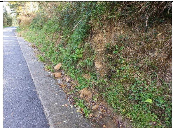
Detalle de la cuneta de pie obstruida por tierras y bloques acumulados. PK 0+230.
