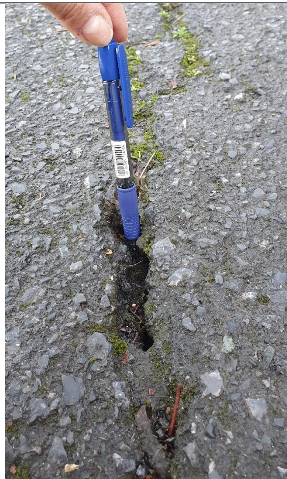
Detalle de grieta en asfalto de apertura de 1 cm aproximado.
