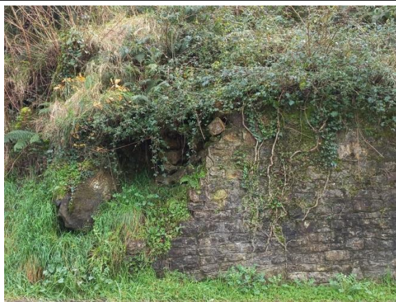
Detalle de rotura del muro. Se observa un bloque métrico de arenisca, posiblemente del propio relleno en trasdós o estructura del muro.
