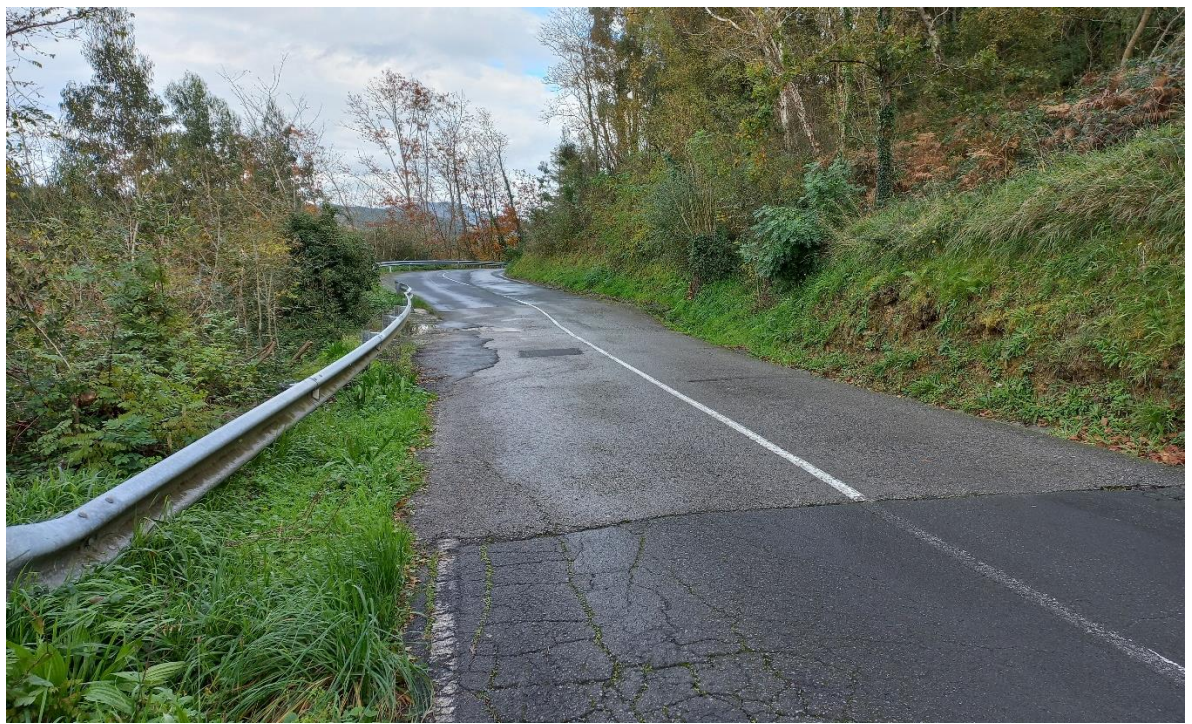
Vista general del inicio del talud H en el PK 0+610. Deformación y patologías generalizadas del firme. Franja reasfaltada entre los PK 0+610-0+620 y grietas de "piel de cocodrilo" a inicio.
