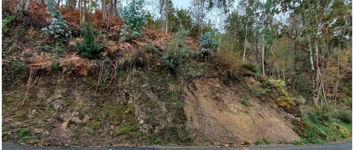
Vista de la cicatriz de la rotura planar en PK 0+510. La coronación del talud se compone de roca completamente alterada a suelos por donde se originan las grietas de tracción facilitando el deslizamiento de los estratos. Se estima una rotura de 5 m 3 .
