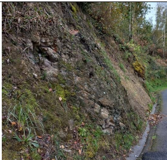
Vista lateral transversal a la rotura planar y estratificación.
