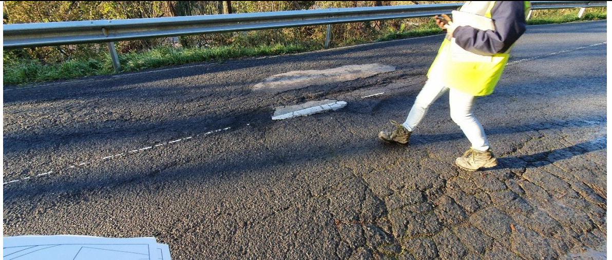
Situación del asfalto en el PK 0+370 con desconches, parcheos y grietas de tipo "piel de cocodrilo".
