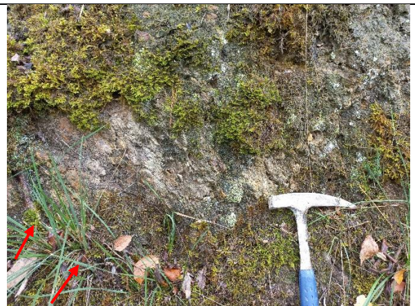
Alternancia milimétrica de areniscas silíceas y limolitas alteradas a GM-IV. Se intuye grieta con apertura de 1 cm. PK 0+340.
