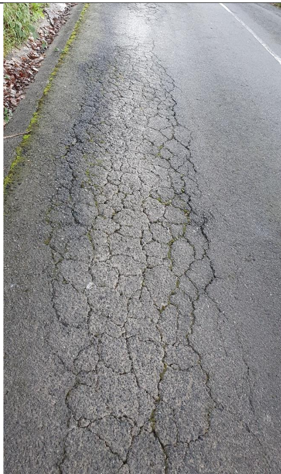
Detalle de las grietas en "piel de cocodrilo" a pie de talud derecho en PK 0+510.
