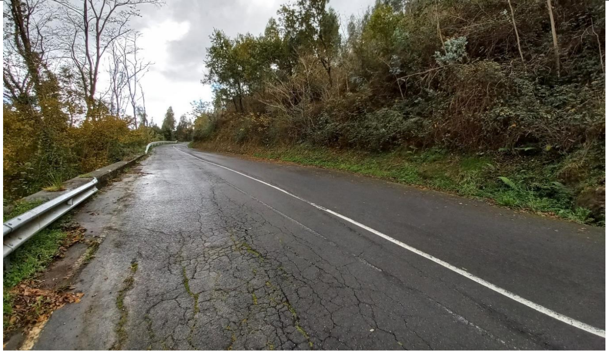
Vista a inicio del talud B en PK 0+120, con grietas de "piel de cocodrilo" en carril izquierdo y grietas longitudinales en la parte central. Muro de hormigón armado con grietas en lateral izquierdo. Sobrancho de 8 m tras sucesivos reasfaltados y modificación del trazado (indicado en rojo) al hundirse la parte exterior del carril izquierdo.
