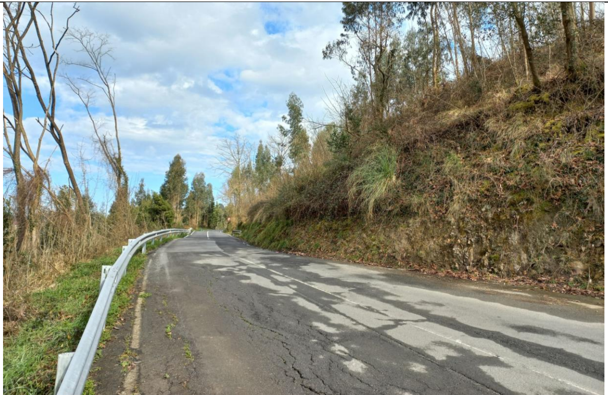
Vista a final del talud tras la curva de PK 0+180. Se continúan observando grietas con apertura cm en el asfalto, así como hundimientos del vial a lo lejos en el PK 0+200. Talud derecho con afloramiento rocoso donde se establece el PL 3.
