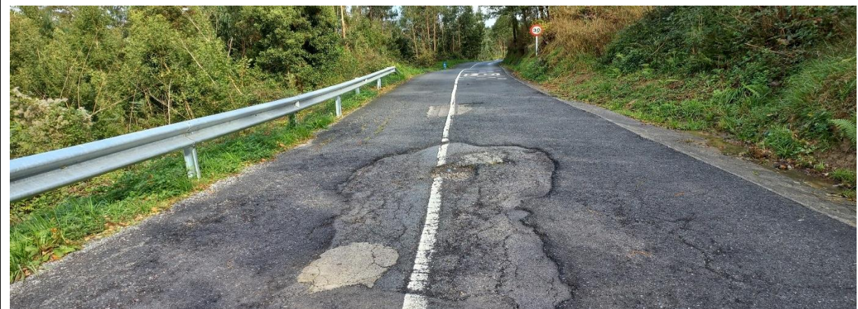
Detalle del deterioro del asfalto con parcheos, oquedades y grietas generalizadas previo al comienzo del talud en el PK 0+250.
