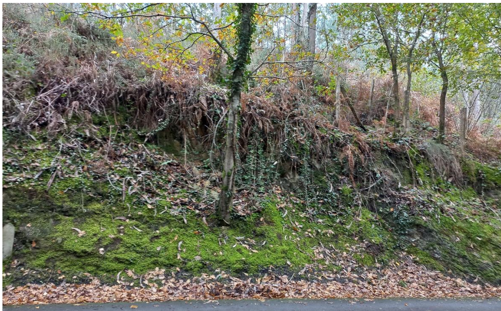
Figura 4.10. Vista del abombamiento en la cara del talud I en el PK 0+980.
