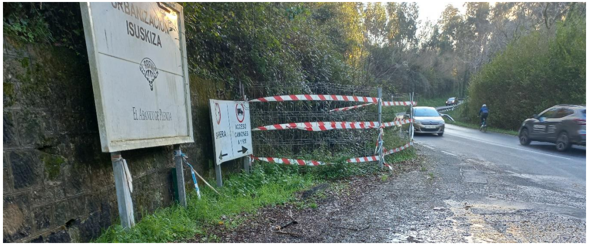
Detalle de rotura reciente del muro vallada. Se desconoce registro de fecha de la rotura. Al fondo se observa la BI-2704.
