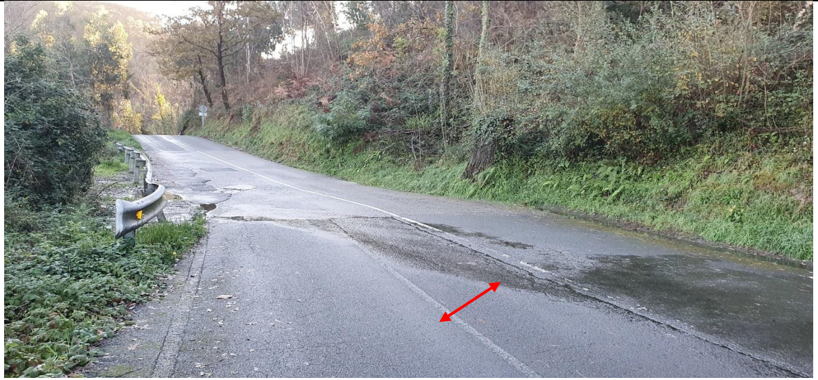
Vista general del talud G. Se observa un hundimiento en la parte central entre los PK 0+570 y PK 0+580, así como grieta longitudinal al trazado. Se aprecia una modificación del eje central del vial (señalado con flechas rojas).
