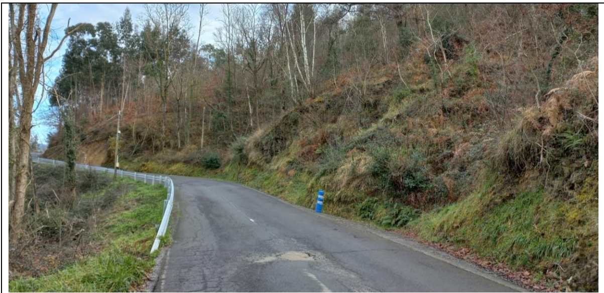
Vista general del talud F. Se observa la masa de derrubios acumulados PK 0+480 y la rotura planar en roca alterada en PK 0+510.
