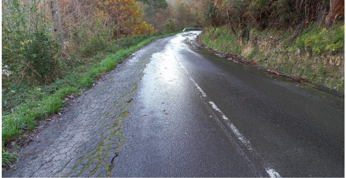
Vista hacia el final del talud I desde el PK 1+020 tras la curva. Se observa un intenso hundimiento en el margen del carril izquierdo así como un intenso agrietado de tipo "piel de cocodrilo". También se observan deformaciones y obstrucciones en la cuneta de pie.
