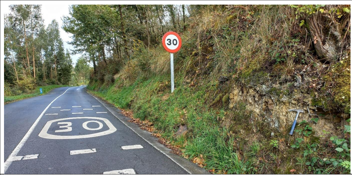
Vista a inicio del talud C. Se observa afloramiento rocoso a inicio con una pequeña rotura donde se establece el PL 5, en el PK 0+270. Se observa junto a la señal, en el PK 0+275, un abombamiento en el talud. Al fondo se aprecia el hundimiento del vial, sobre el PK 0+290.
