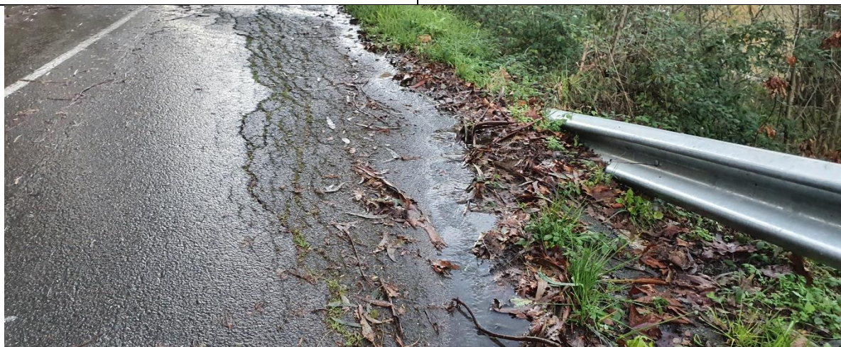
Detalle del intenso hundimiento a lo largo del margen del carril izquierdo, del orden de 15 cm de hundimiento, así como un intenso agrietado de tipo "piel de cocodrilo" en el PK 1+080.
