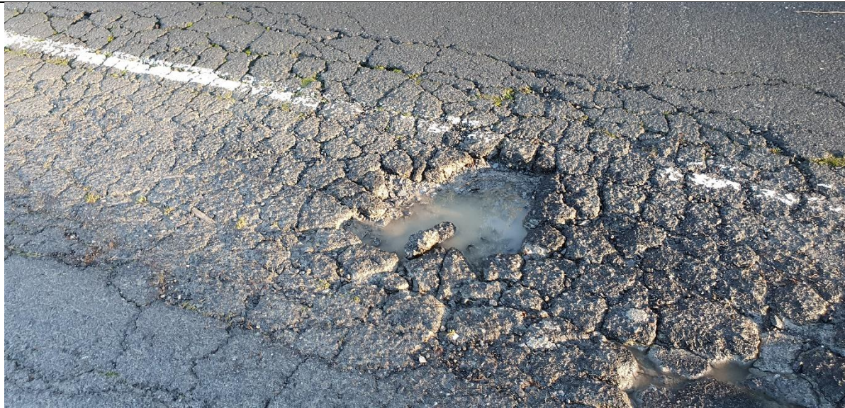
Detalle de oquedad en el centro del agrietado en "piel de cocodrilo", en PK 0+380.
