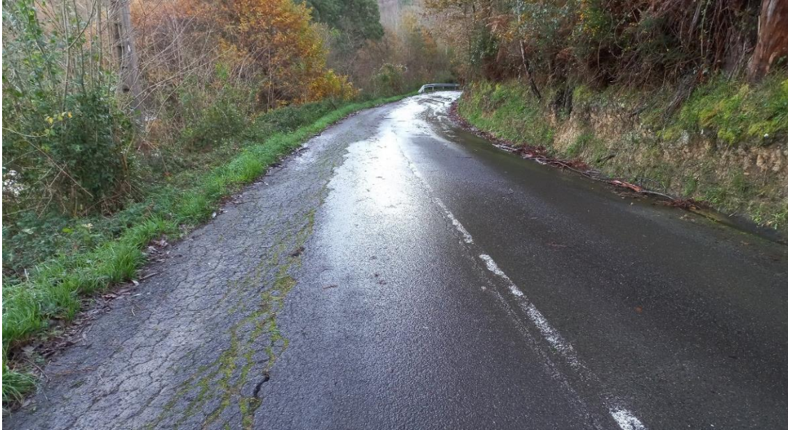
Figura 4.13. Parte final del talud I, en el tramo susceptible de generar vuelcos. Se observan patologías a pie de talud y en margen del carril izquierdo.
