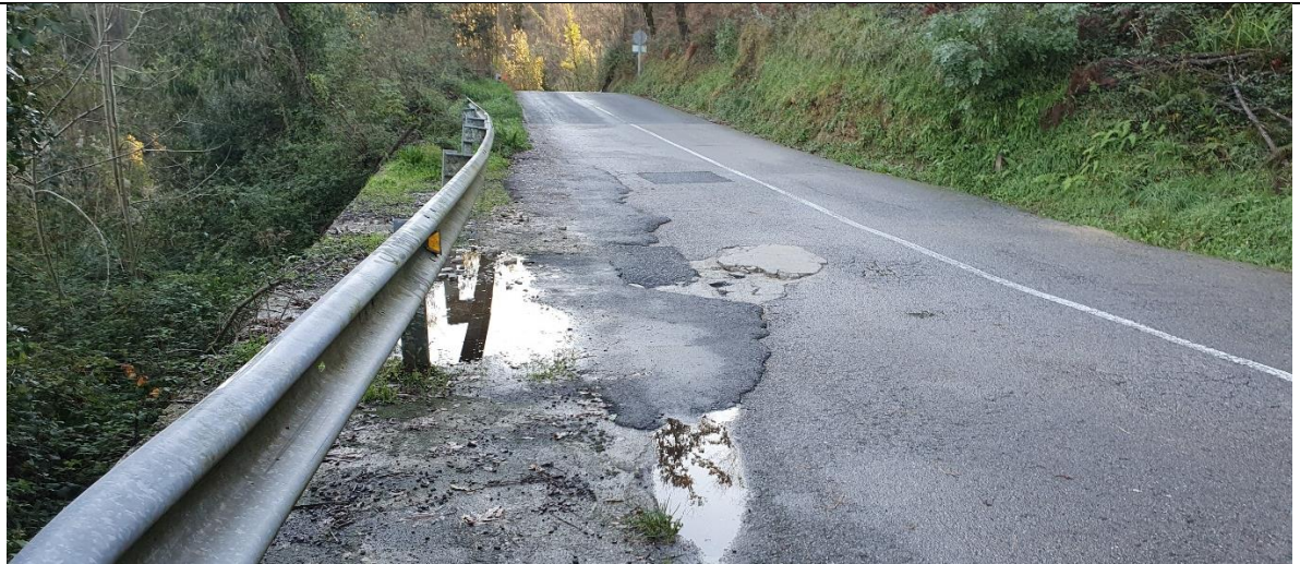
Detalle de patologías en firme al comienzo de la zona deprimida con varios parcheos, grietas y zonas encharcadas, en PK 0+570.
