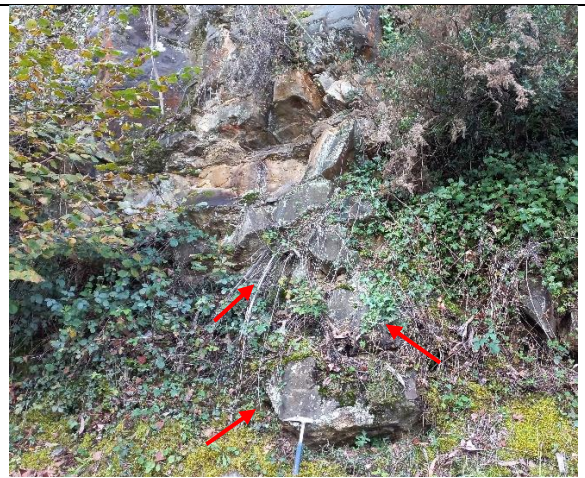
Detalle de bloques de arenisca de en torno a 0.15-0.25 m 3 acumulados a pie de talud en el PK 1+350. Se aprecia la cicatriz de la rotura en color beis.
