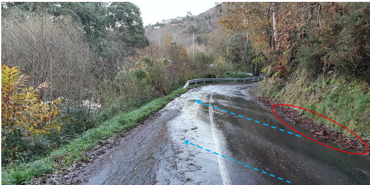
Figura 4.15. Vista del PK 1+100 del talud I. Se observa la cuneta de drenaje de pie de talud colmatada por hojarasca (círculo rojo) y escorrentía superficial (trayectoria azul) que parte de la cuneta hacia el margen del carril izquierdo, infiltrándose por las grietas.
