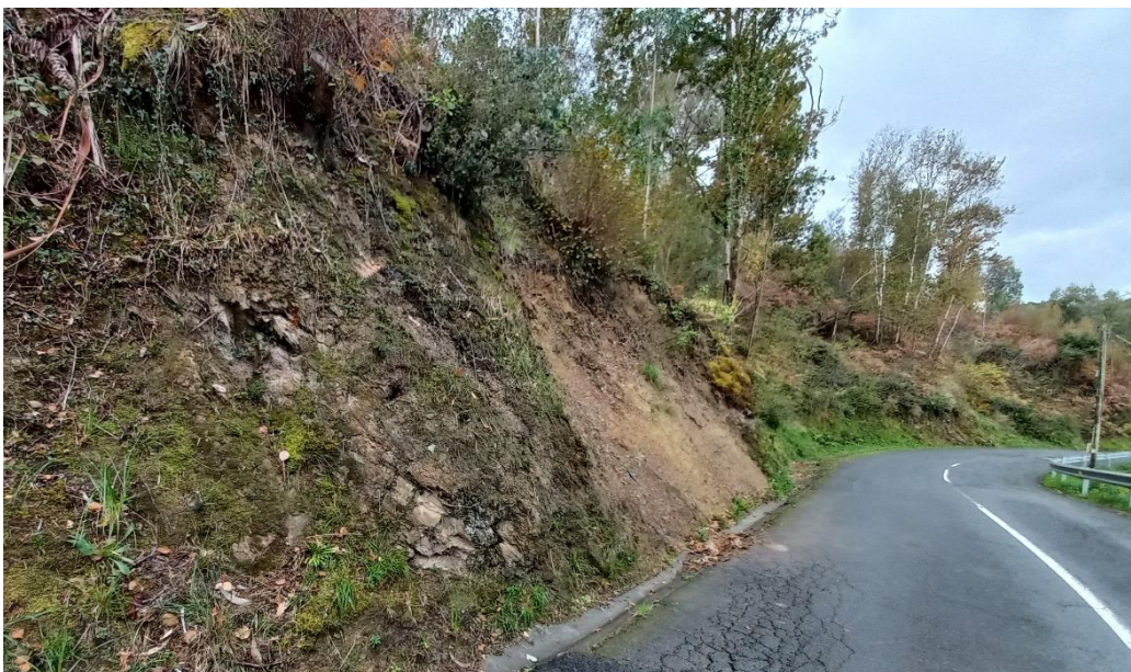
Figura 4.12. Vista de la rotura planar del talud F, en el PK 0+510.
