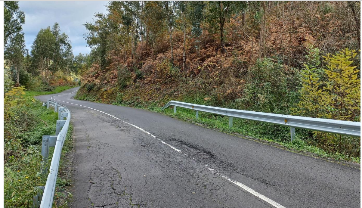
Vista general del talud D tras vaguada. Deterioro avanzado del firme con oquedades y grietas tipo “piel de cocodrilo” en PK 0+310.
