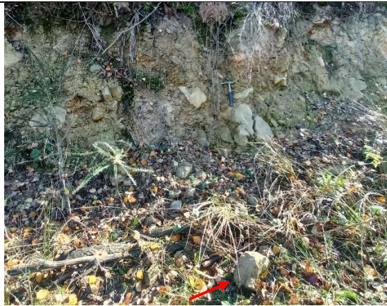
Bloques de tamaño centimétrico a decimétrico desprendidos de la cara del talud por un posible lavado del suelo arcilloso.
