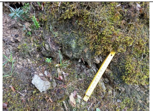
Detalle de la apertura de la grieta anterior del PK 0+350.
