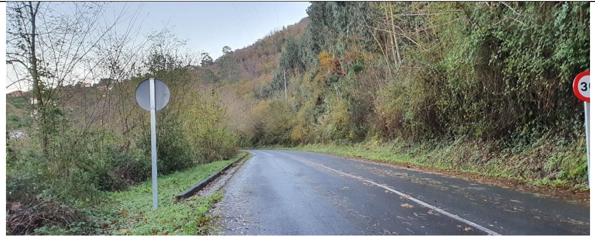
Vista inicial del talud K desde su inicio en el PK 1+450. Se observa abundante hojarasca acumulada en la cuneta de pie de talud.
