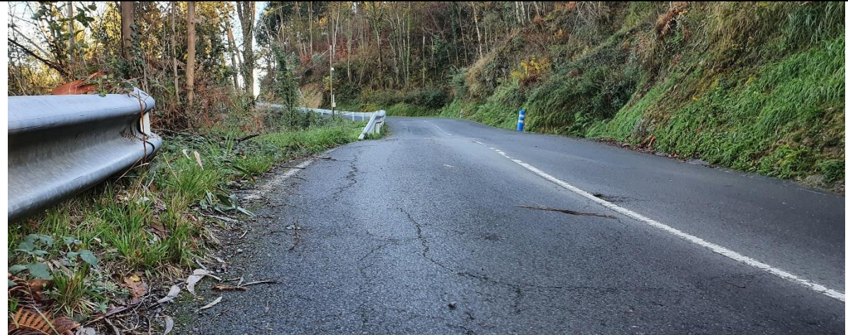
Detalle de las grietas longitudinales del asfalto a inicio del tramo en PK 0+430. Se observa un hundimiento en PK 0+430.
