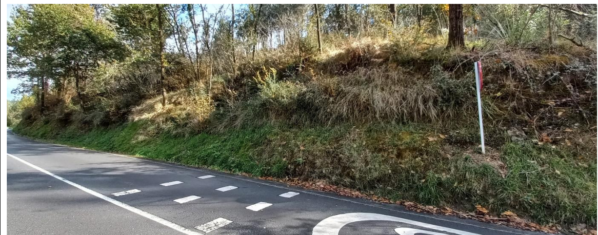
Detalle del abombamiento y deformación en la cara del talud en el PK 0+275.
