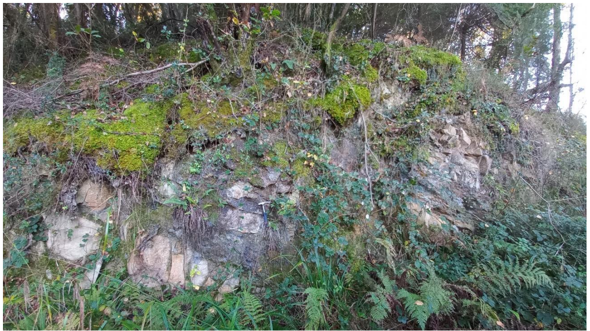
Vista general del inicio del talud con afloramiento de areniscas donde se establece el PL 25.
