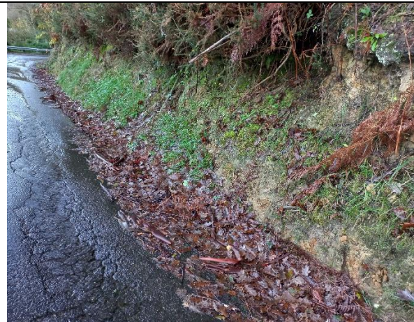
Detalle del pie de talud con grietas tipo "piel de cocodrilo" y cuneta de pie completamente obstruida, en PK 1+060.
