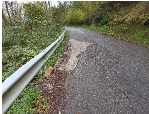
Detalle de lateral izquierdo del vial, con parcheos y agrietado longitudinal con apertura mm. PK 0+020.
