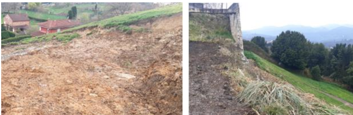
FIGURA 1.8. En la imagen de la izquierda se observa la cicatriz del deslizamiento, y a la derecha el muro de hormigón armado afectado.
