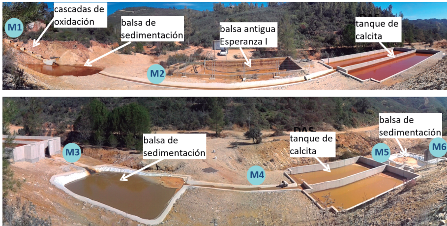
Fig. 3. El sistema de tratamiento pasivo de Mina Esperanza II. Obsérvese el diferente color de los precipitados de Fe (III) en los dos tanques de DAS-caliza: rojo (schwertmannita, pH 3) y naranja (ferribidrita, pH 6). Los puntos de muestreo se han notado con la letra M
