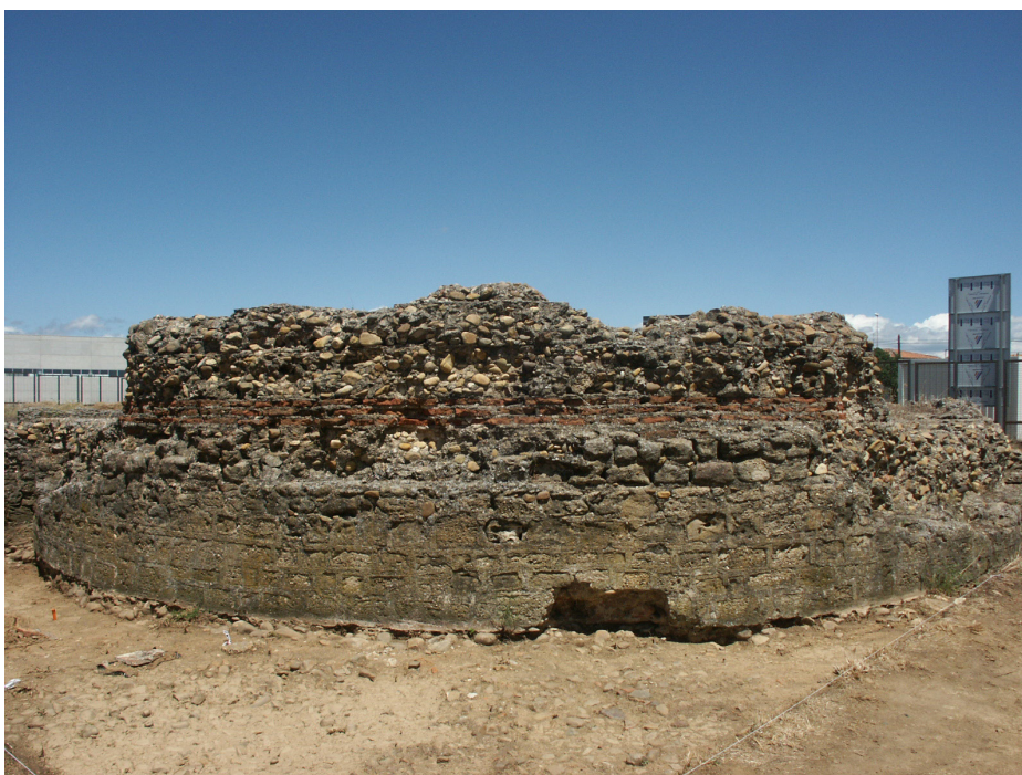
Fig. 3. Exterior de la cabecera en la que se aprecia la técnica constructiva con opus caementicium , hiladas de ladrillos y paramento exterior con juntas resaltadas (fotografía A. Gutiérrez)
