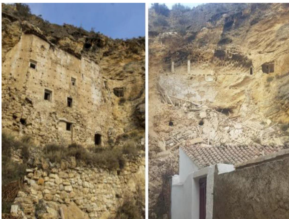
Imagen 2 Palacio de Inestrillas antes y después del derrumbe. En: Elpais.com
