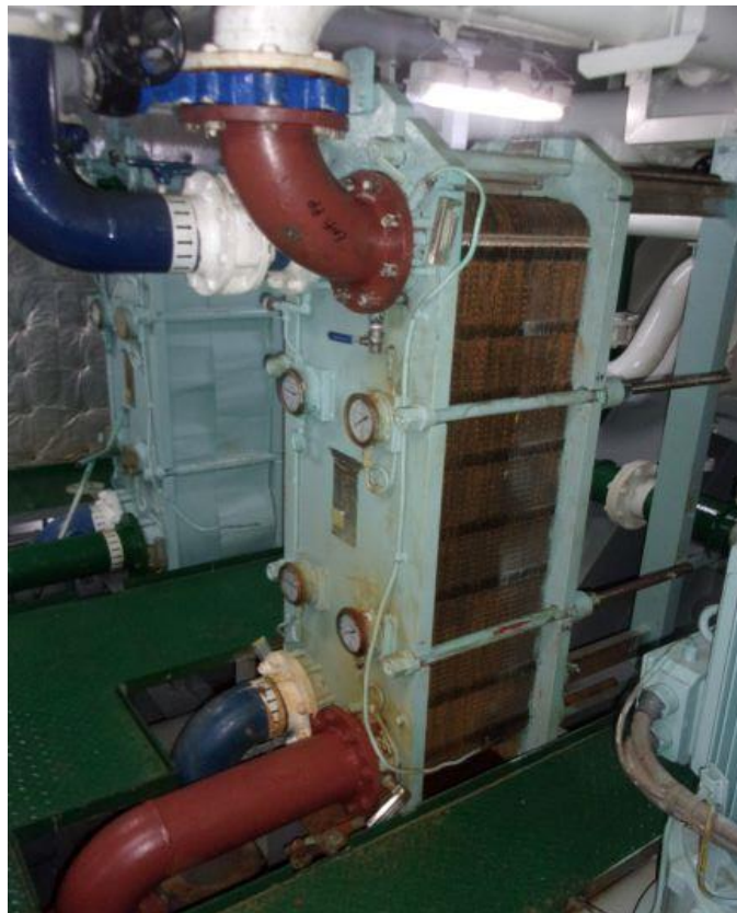
Figura 21-Enfriador de agua de baja
