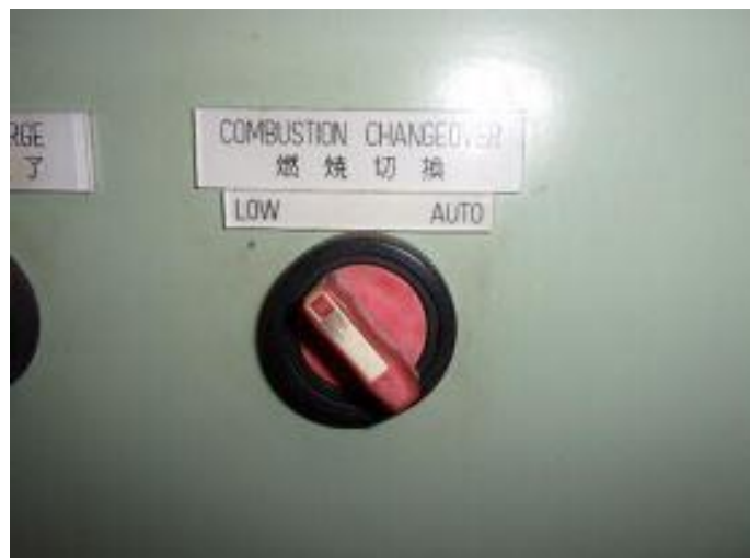
Figura 26-Caldera "Miura": modo de combustión
