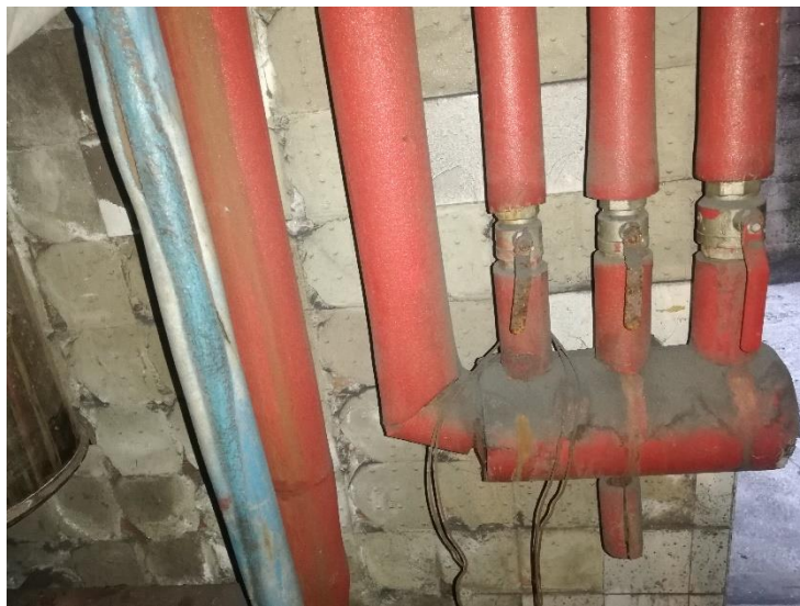
Figura nº123. Colector de impulsión del sistema de calefacción de la Casa de la Cultura.
