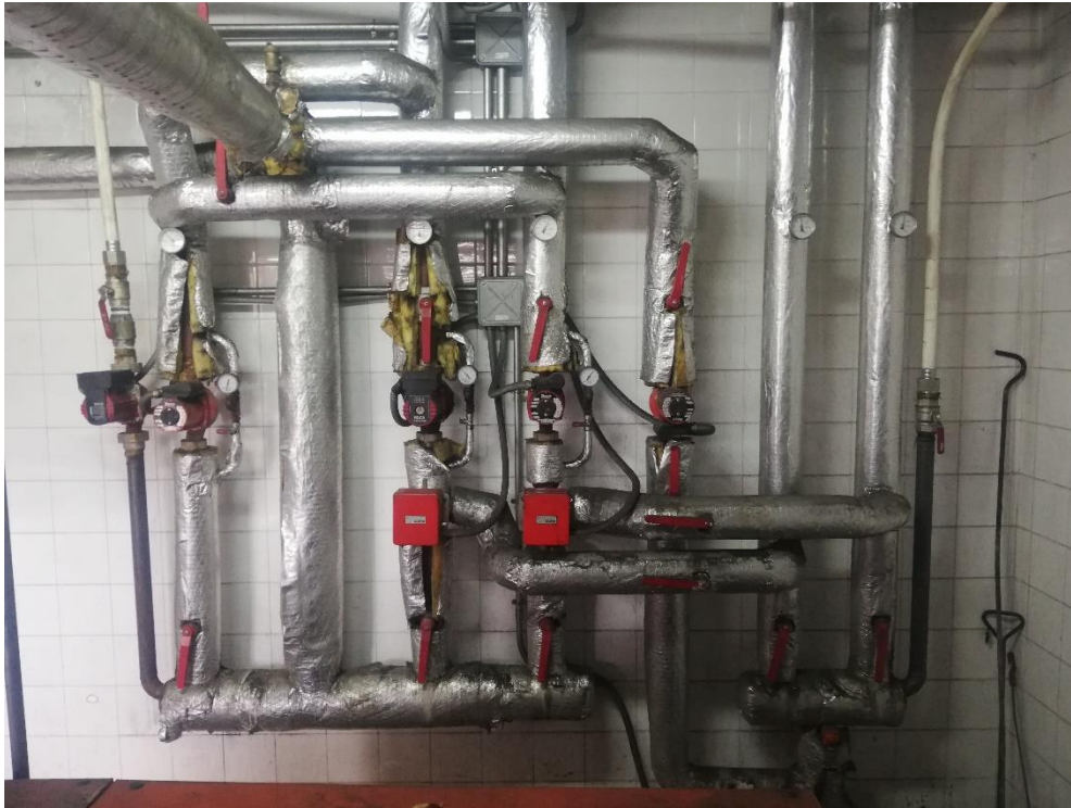
Figura nº127. Colectores térmicos del edificio de la entrada del IES Obispo Argüelles.
