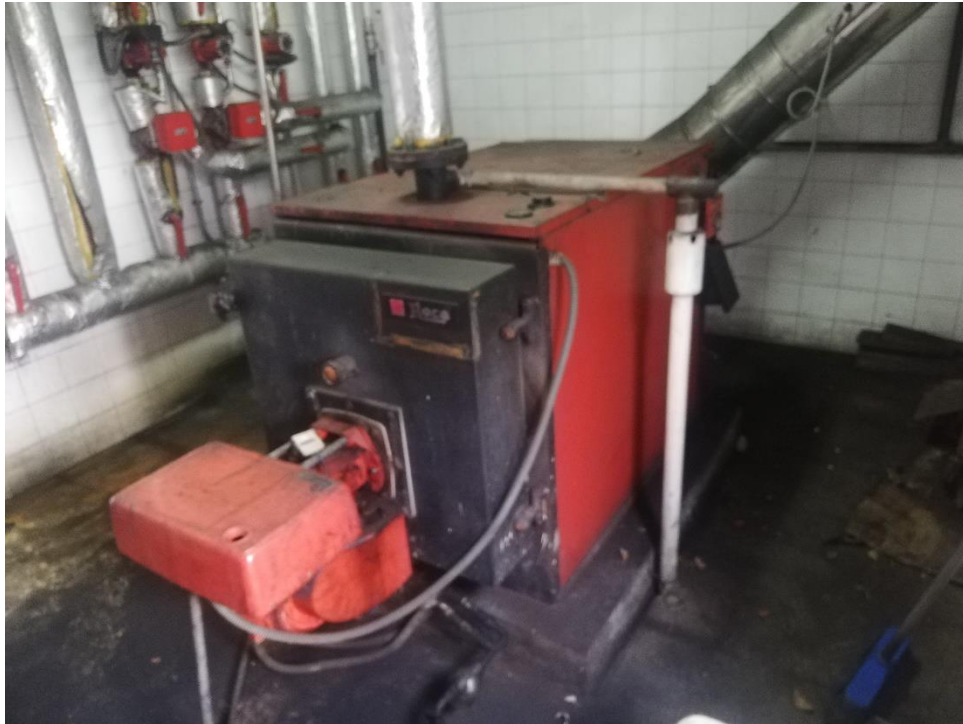
Figura nº62. Caldera del edificio de la entrada del IES Obispo Argüelles
