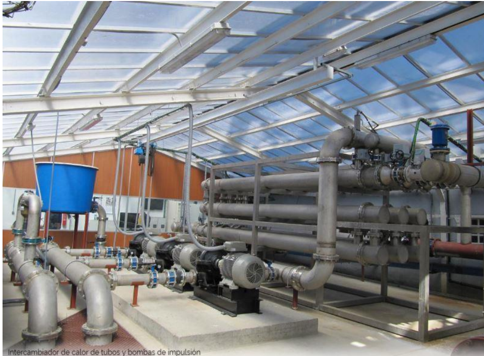
Figura nº11. Intercambiador de calor y bombas de la red del hospital Álvarez-Buylla (HUNOSA 2012)
