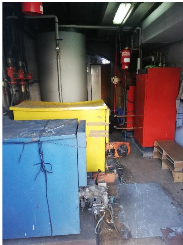
Figura nº71. Calderas de apoyo de gasoil en el polideportivo de Villablino (rojas).
