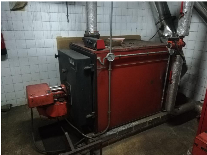
Figura nº60. Caldera del edificio principal IES Obispo Argüelles
