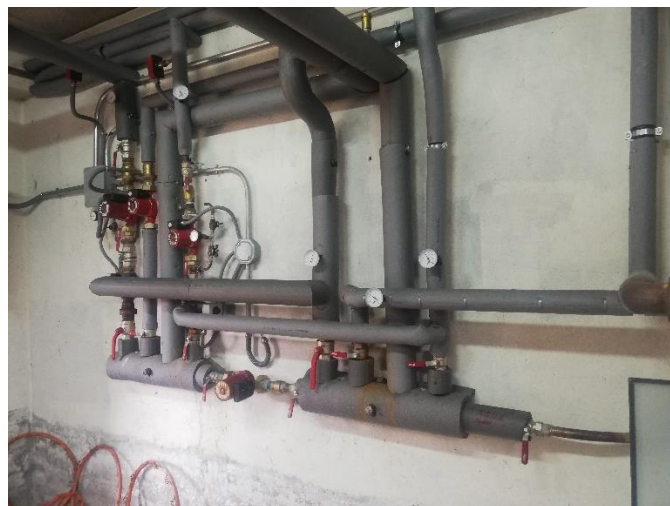
Figura nº128. Colectores del sistema térmico del gimnasio del IES.
