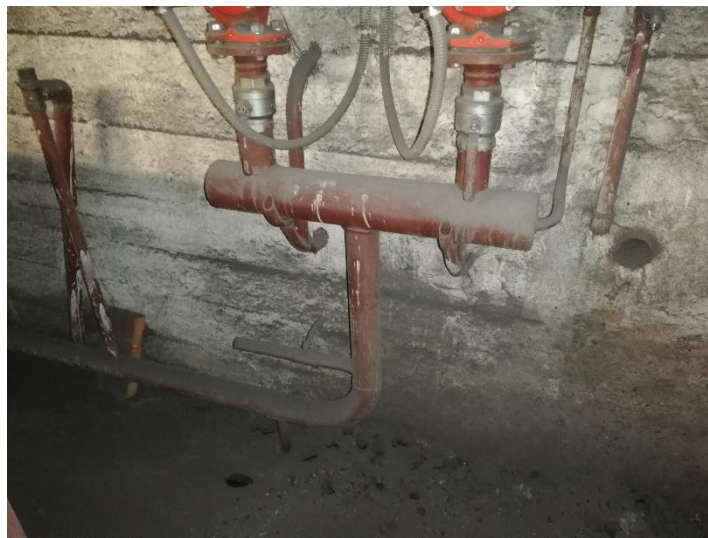
Figura nº125. Colector de impulsión del sistema de calefacción del Colegio Público San Miguel.
