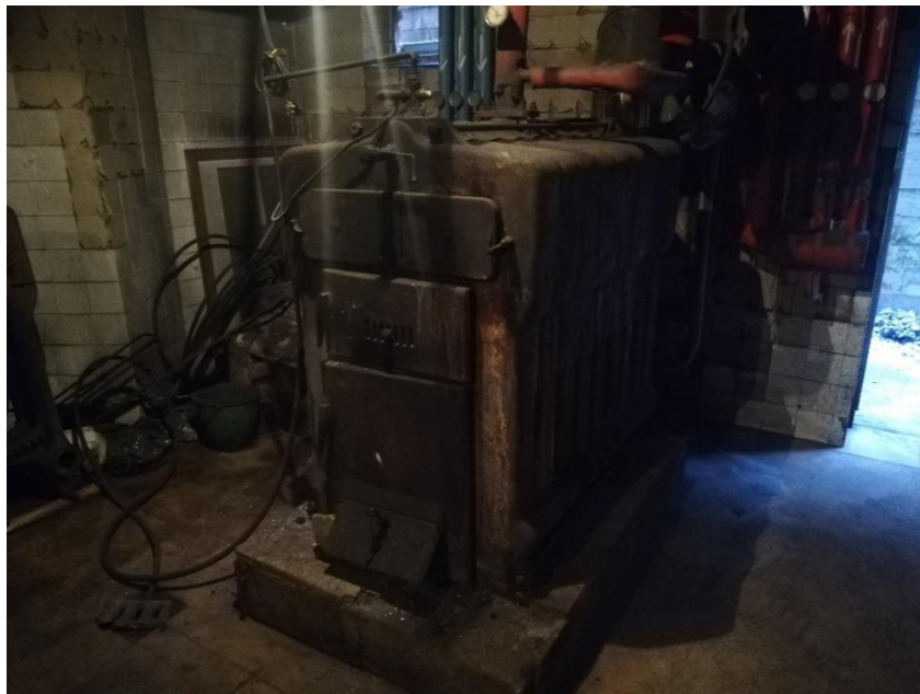
Figura nº68. Caldera de carbón de la Casa de la Cultura de Villablino
