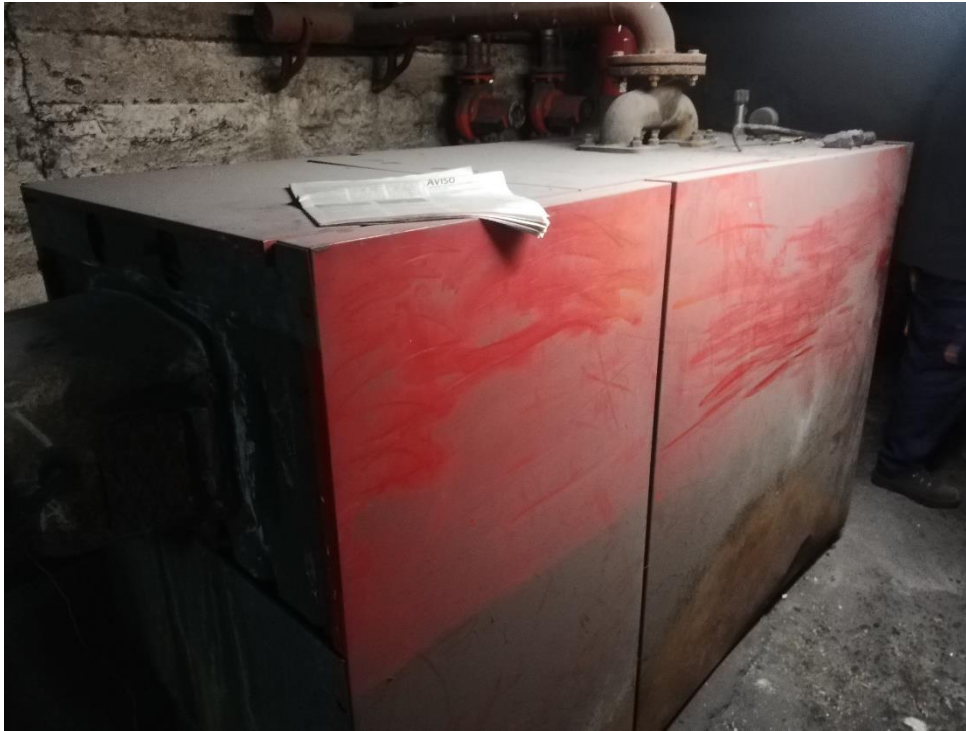
Figura nº73. Caldera de la sala técnica del CEIP San Miguel de Villablino.
