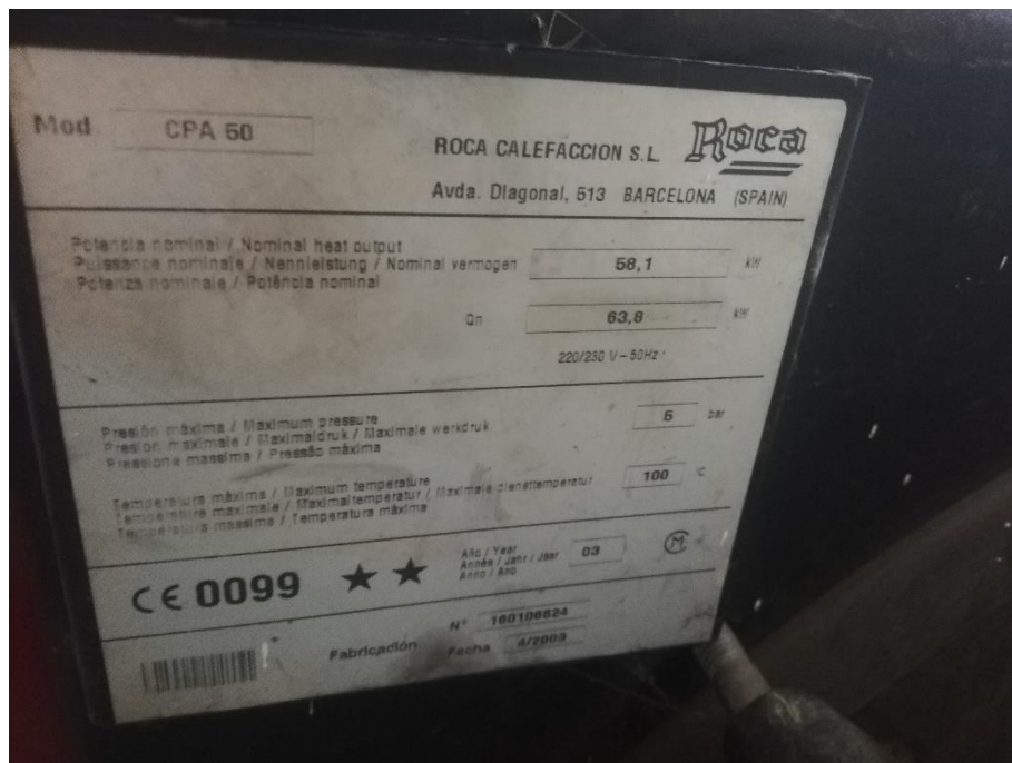
Figura nº64. Calderas del gimnasio del IES Obispo Argüelles
