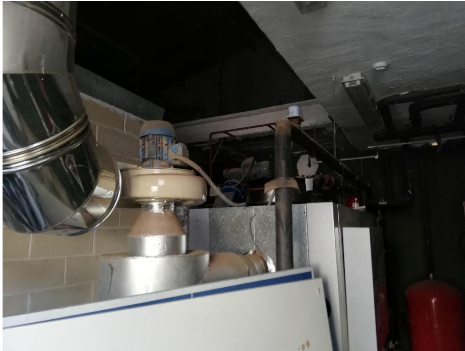
Figura nº70. Caldera de biomasa del polideportivo de Villablino.
