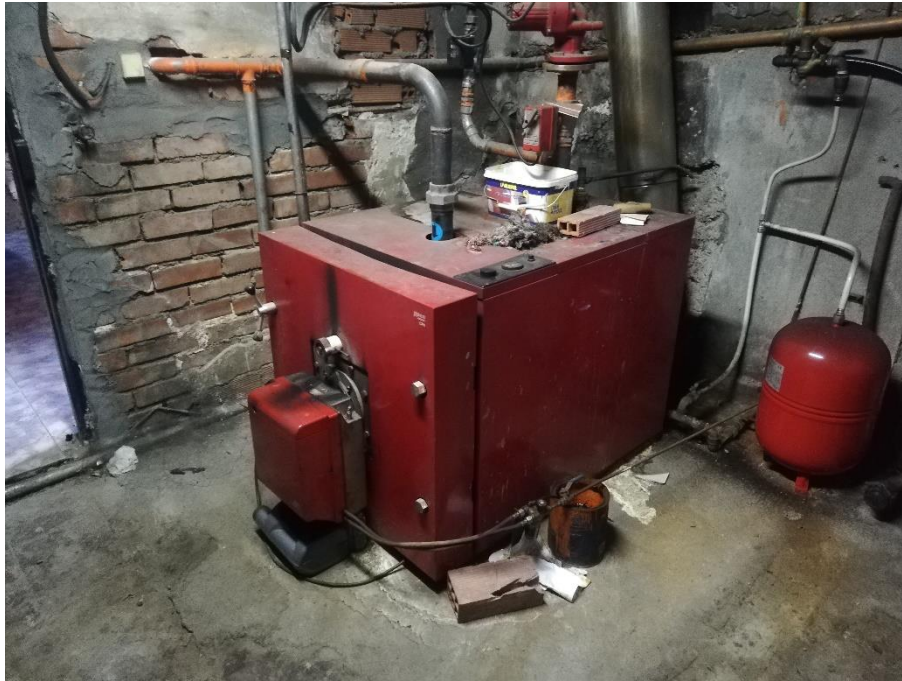
Figura nº66. Caldera del Ayuntamiento de Villablino.
