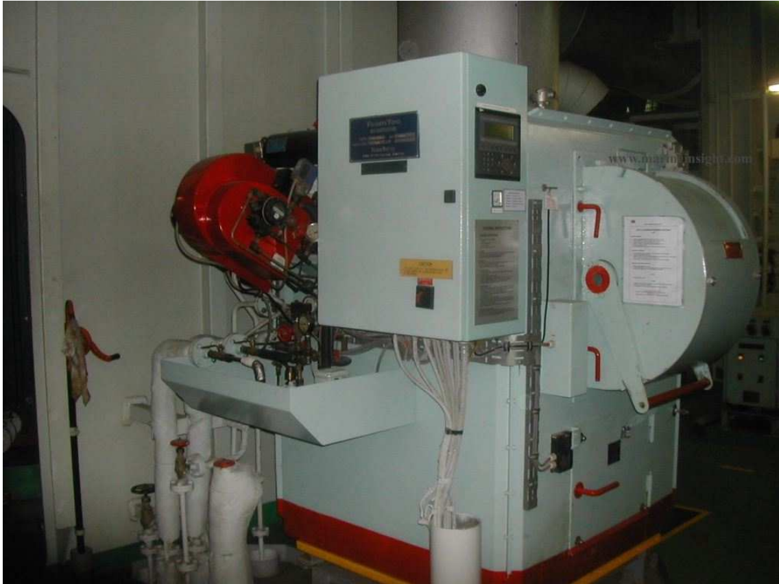
Figura 12. Incinerador de basuras
