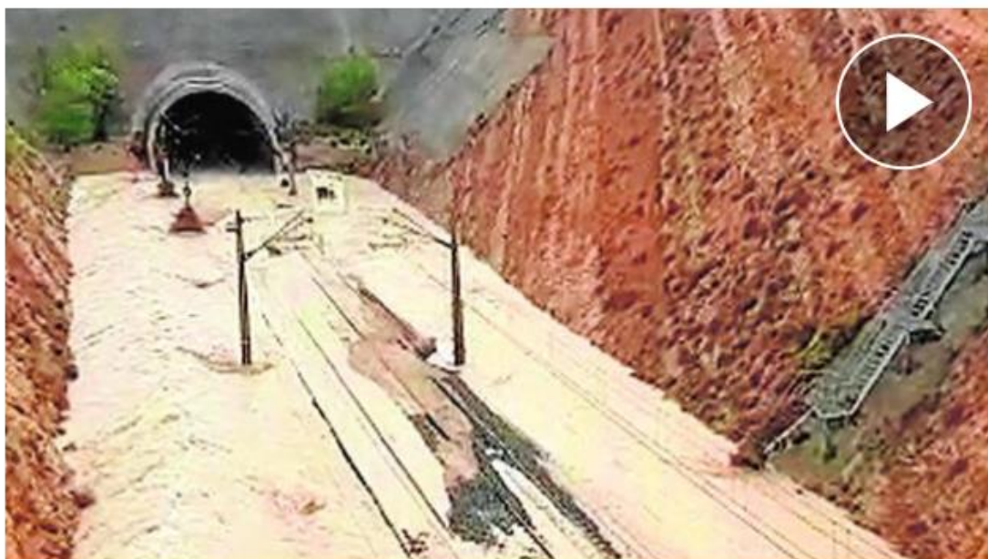
La Font de la Figuera. El túnel del AVE totalmente anegado por el agua. / LP
