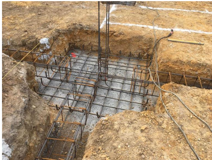
Figura 11. Armadura de la zapata sobre el hormigón de limpieza. Fuente: Google Imágenes.
