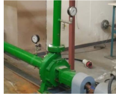
Figura 19 – Detalle de la bomba, el vacuómetro y el manómetro.
