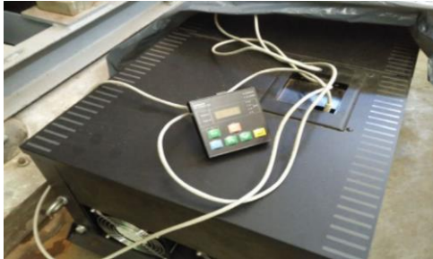
Figura 23 – Detalle del regulador de frecuencia.
