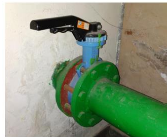
Figura 20 – Detalle de la válvula a la salida del tanque.
