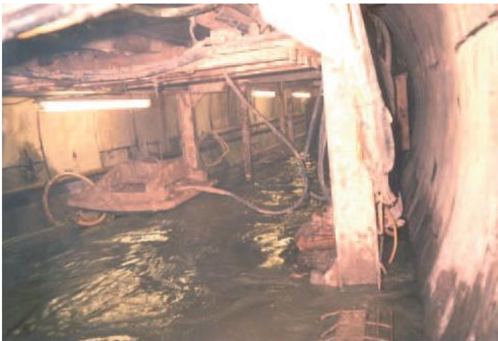
Figura 8.- Inundación del túnel de Tooting Bec, al sur de Londres y excavado en la Formación Upnor. Fue necesario instalar un sistema de congelación del terreno para completar el túnel de lanzamiento de la tuneladora. Tomado de Newman (2009).
