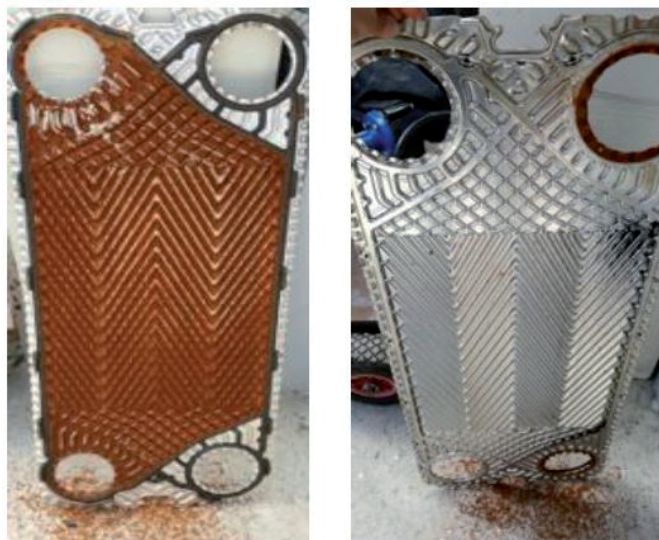
Fig. 5. Placa de intercambiador de calor en el Campus de Mieres. Izqda.: lado afectado por precipitados de hierro, dcha.: lado no afectado
