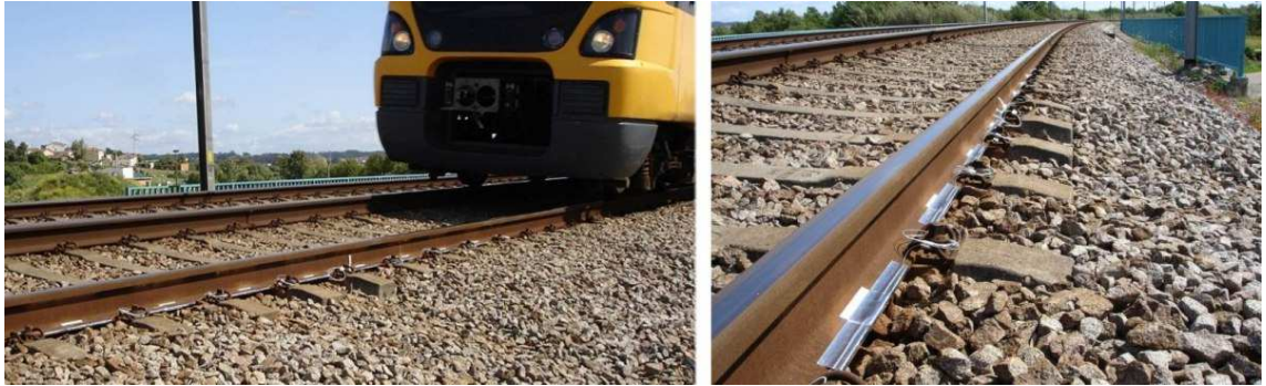
Figura 75 Sensores de deformación y temperatura instalados en los raíles.
