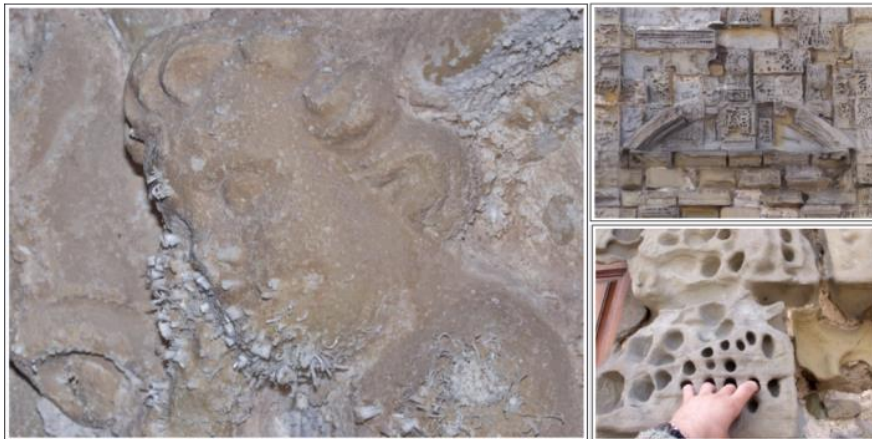
Figura 1. Cristalización de sales. Izquierda: Eflorescencias 1 salinas en el retablo pétreo de una de las capillas laterales en el Monasterio de Yuso (La Rioja). Derecha: Detalle de los importantes procesos de deterioro que pueden generar los mecanismos de cristalización de sales. En este caso se trata de procesos de alveolización 2 sobre las superficies pétreas de la fachada de la iglesia de San Lorenzo (Gijón), provocando importantes pérdidas de volumen de los sillares. (Mateos et al., 2016).
