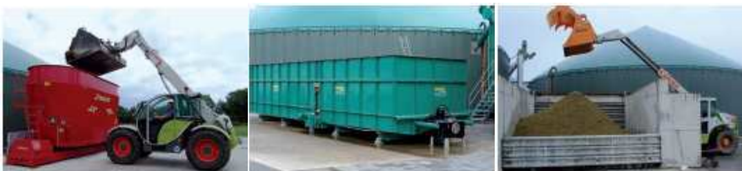
Figura 10. Alimentadores de sustratos a los digestores. Fuente: Bentec
