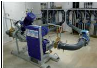
Figura 8. Bomba de los digestores. Fuente: Bentec
