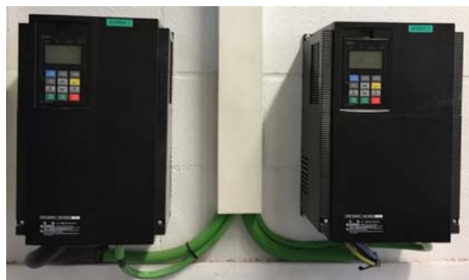
Fig.105 Fotografía de los variadores instalados en el laboratorio
