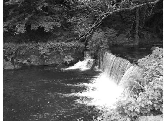
FIGURA 2. La Estacada las Veigas (La Puela, Ayande). Ejemplo de estacada construida en piedra, al fondo se observa el muro de contención del canal saliente y el derroucadoiru liberando agua del mismo.
