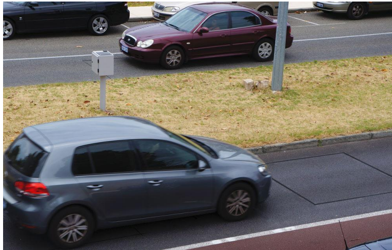
Figura 2.3.- Lazo inductivo en la carretera.
