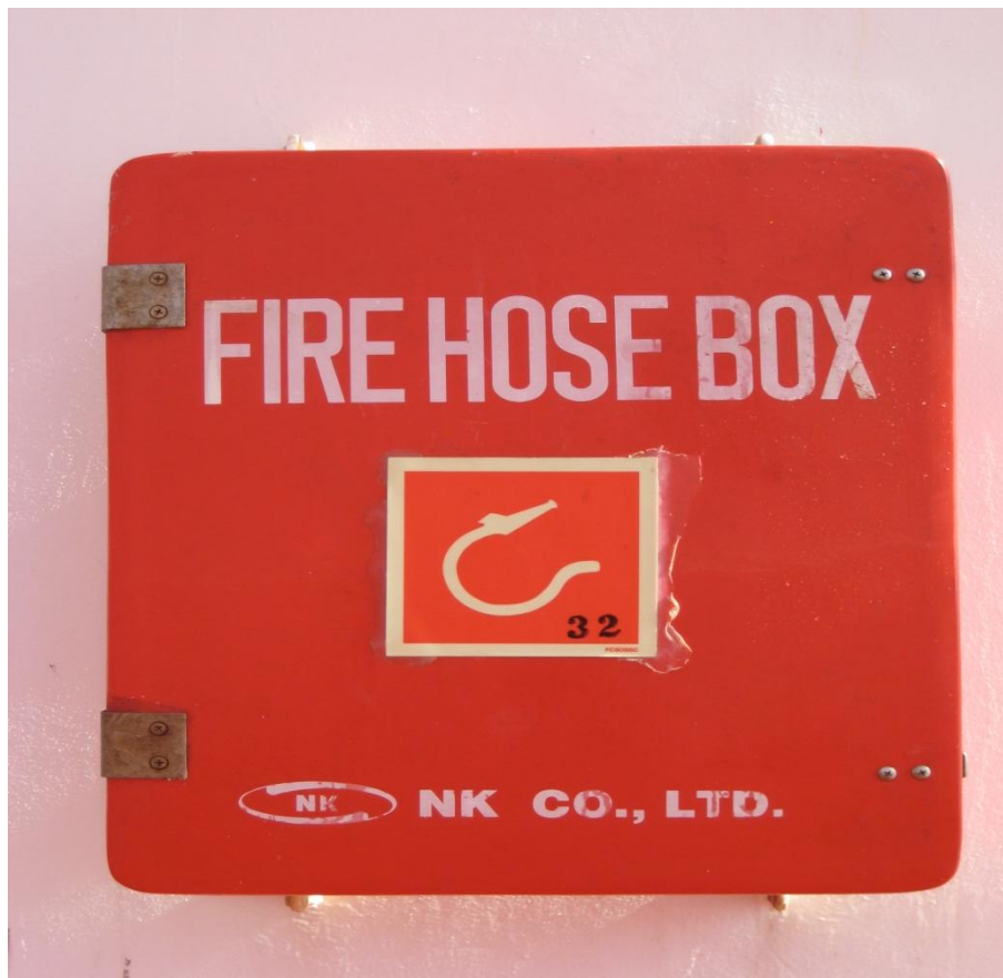
Figura 15: Caja contra incendios dispuesta por el buque
