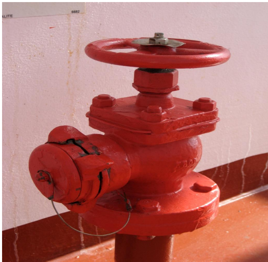
Figura 13: Hidrante de cubierta
