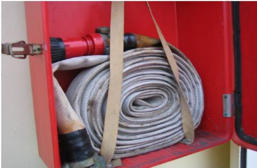
Figura 16: Manguera estibada en su caja
