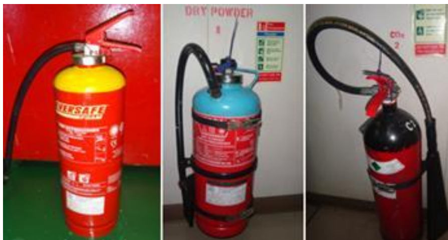
Figura 18: Distintos tipos de extintores de un buque
