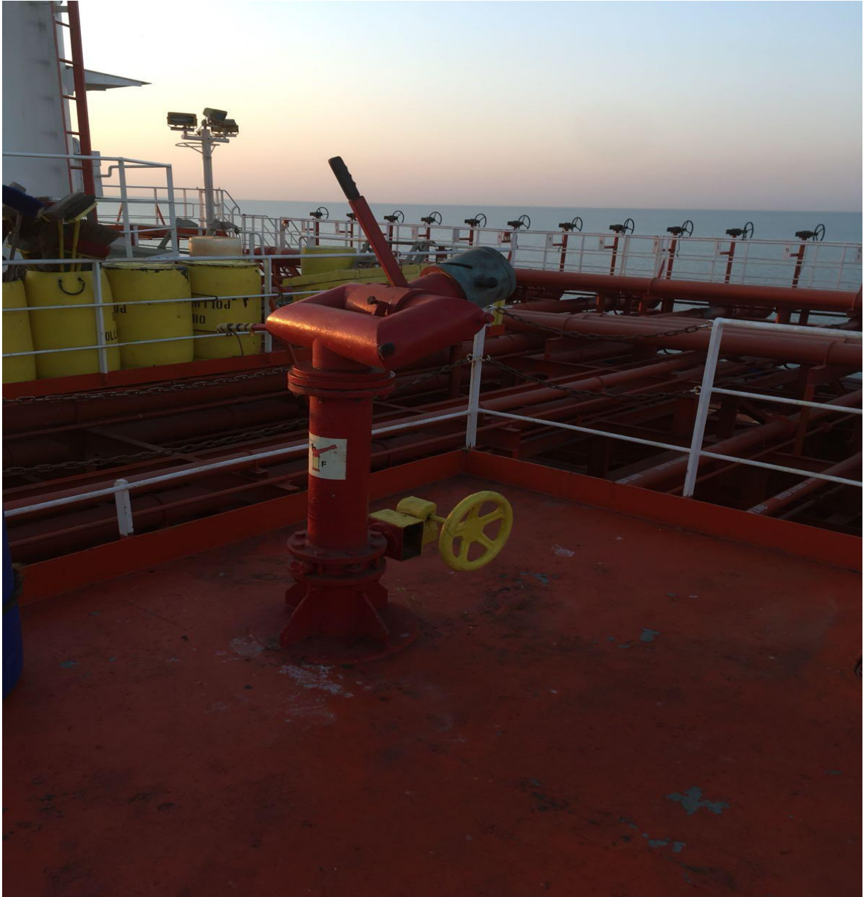
Figura 7: Monitor de espuma de cubierta
