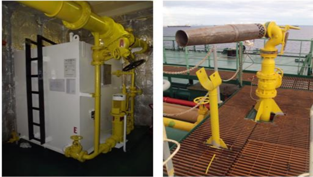
Figura 5: Tanque y cañón de espuma
