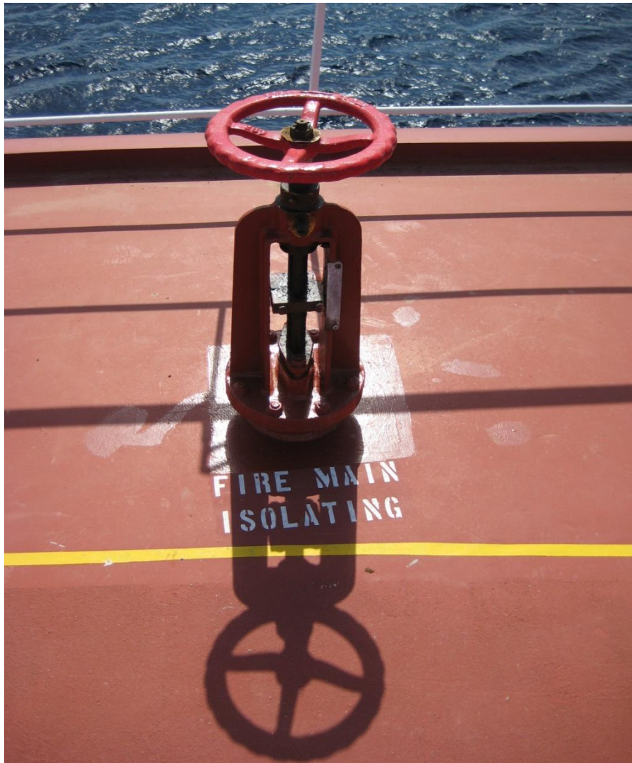
Figura 14: Válvula de aislamiento de cubierta
