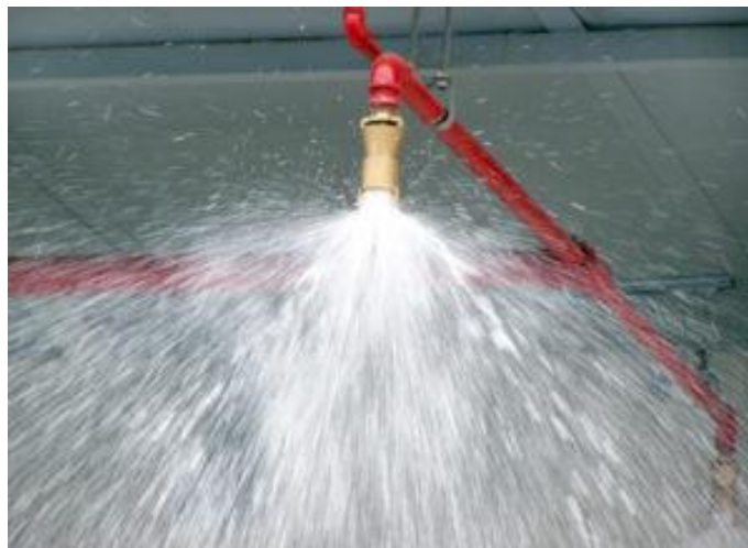
Figura 9: Rociador automático de agua
