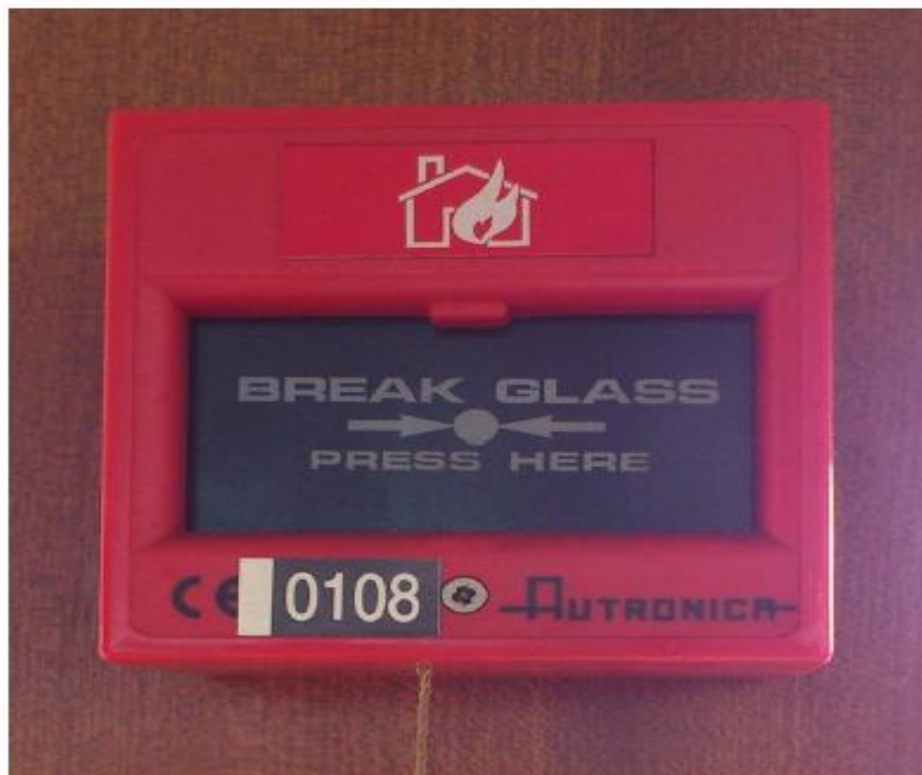
Figura 8: Pulsador manual de la alarma contra incendios
