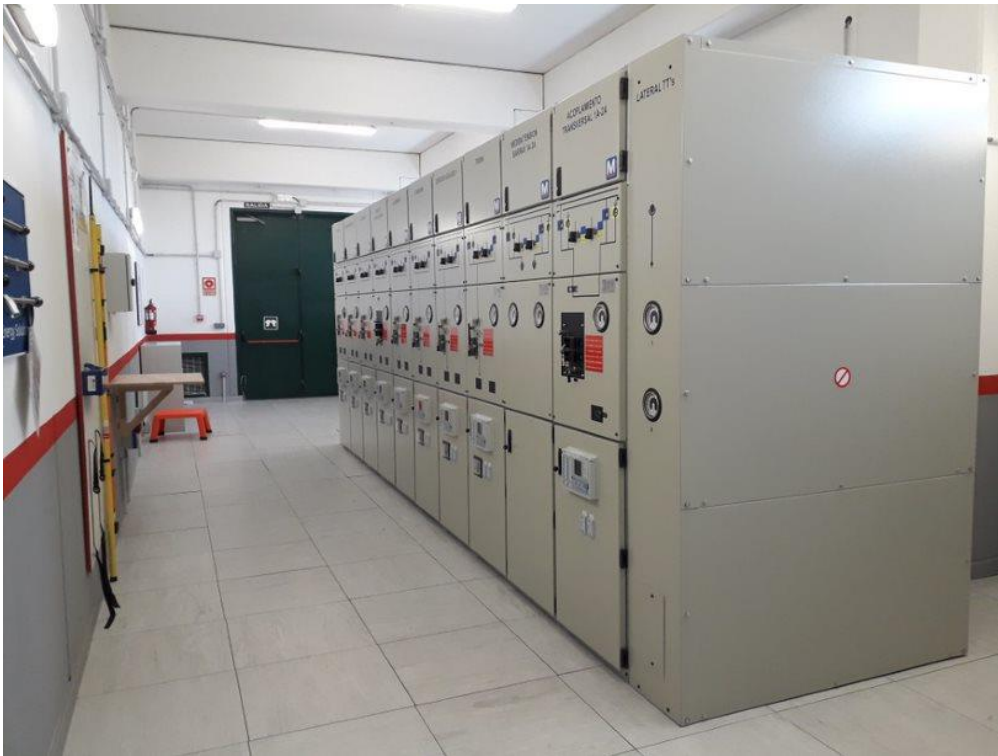
Figura 7.13 Ubicación final de las cabinas en la sala de 20 kV del edificio de la SE Romió
