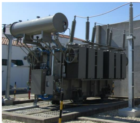
Figura 3.1 Transformador de 132/20 kV y 30 MVA que se instalará en la S.E. de Romió
