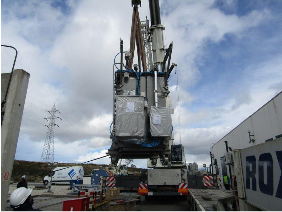
Figura 7.7 Descarga del transformador del camión
