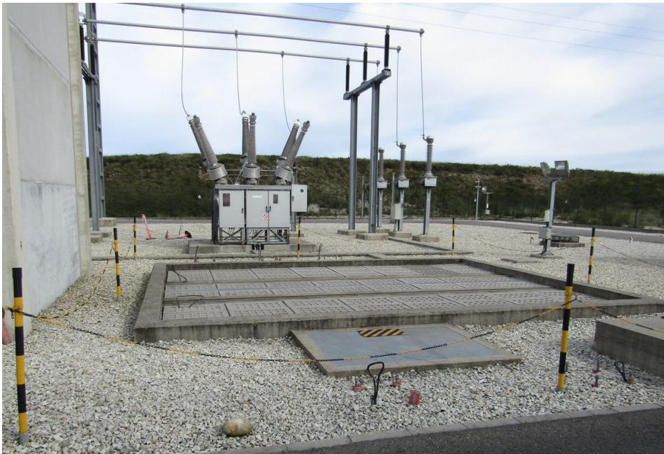
Figura 4.4 Espacio destinado al transformador de 132/20 kV y 30 MVA en la subestación de Romió
