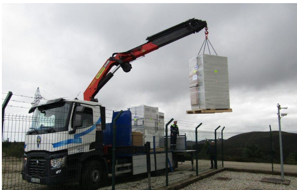
Figura 7.10 Descarga de las cabinas de 20 kV
