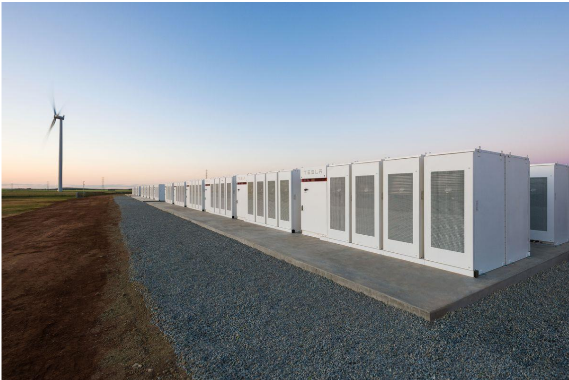
Figura 44. La mayor planta de baterías de iones de litio de Tesla en Australia. Fuente:
