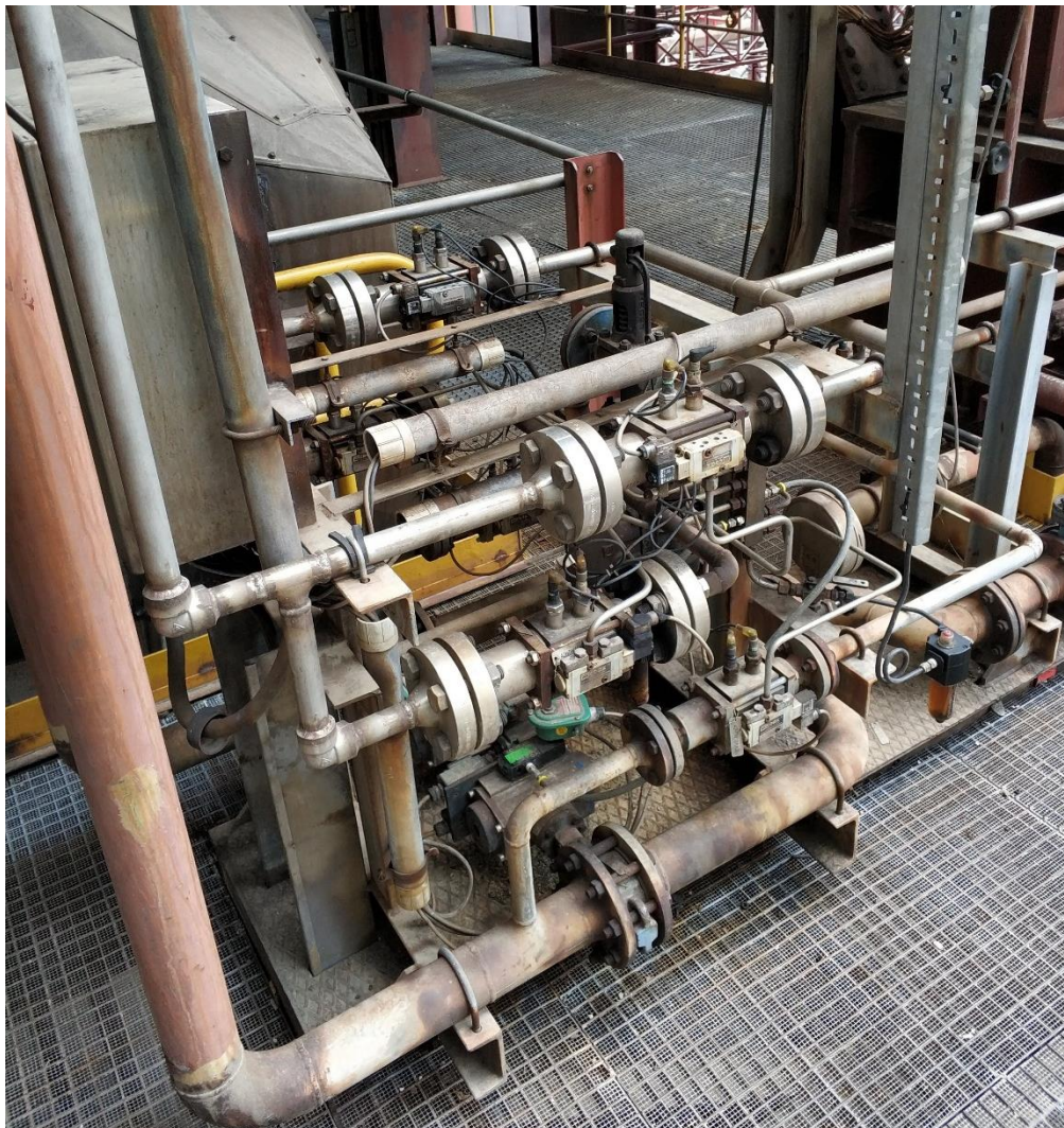
Imagen 6.5. Tren de válvulas actual del circuito de aire-agua
