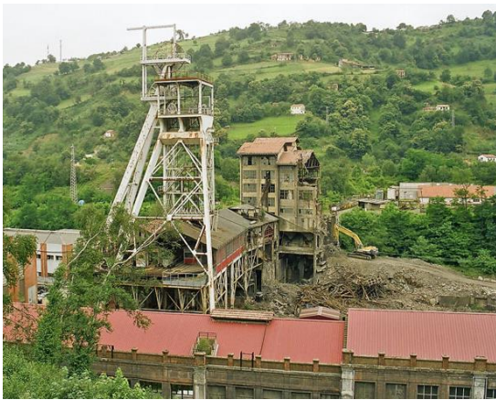
Fig.21: Lavadero del Pozo María Luisa en proceso de demolición, 2002. Fuente: Archivo Histórico de HUNOSA.
