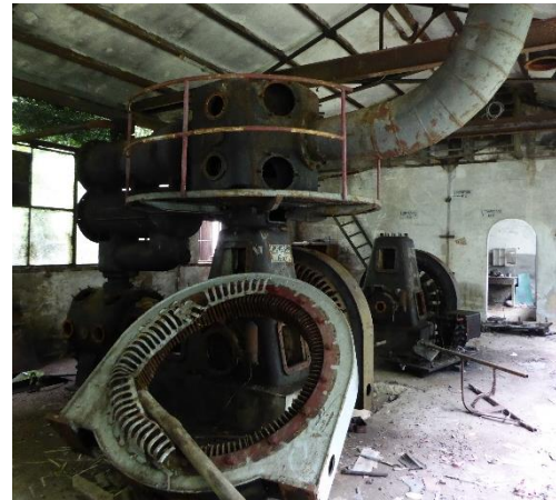
Fig.12: Interior de la sala de compresores.
