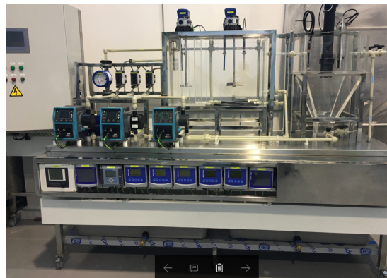
Figura 1: Planta experimental de tratamiento de aguas residuales.
