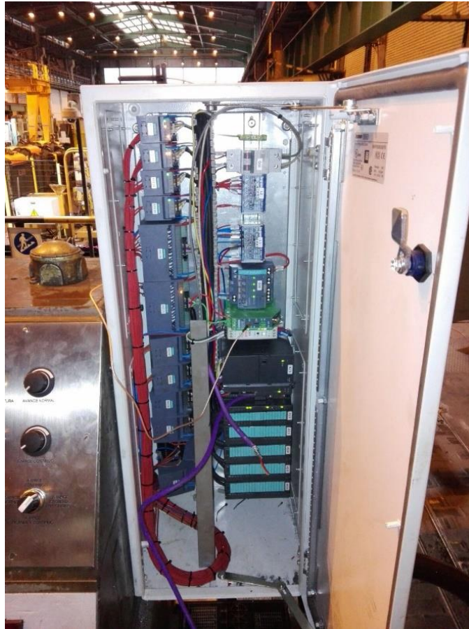
Figura 3.10 Remota del plc
