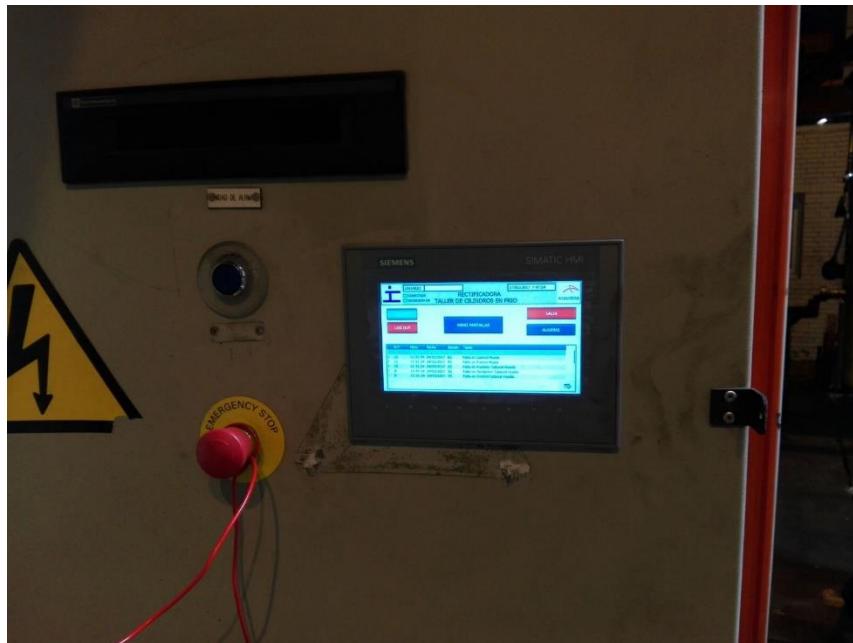
Figura 3.6 HMI en armario eléctrico
