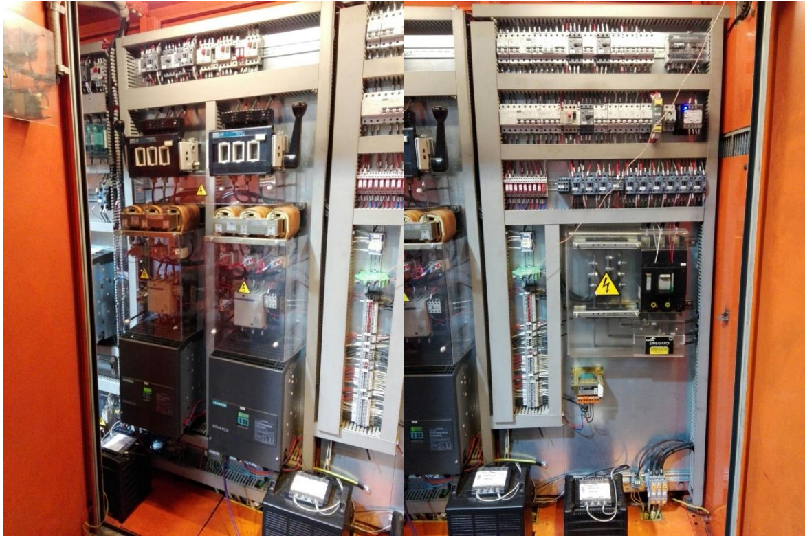
Figura 3.8 Placas 3 y 4 del armario eléctrico
