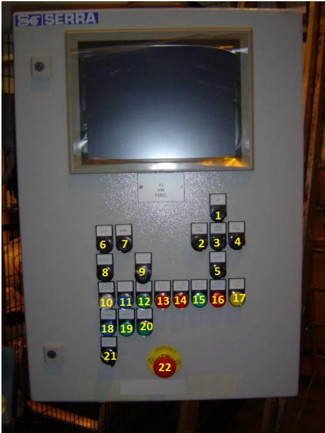
Figura 1: Panel principal de control de la estación.
